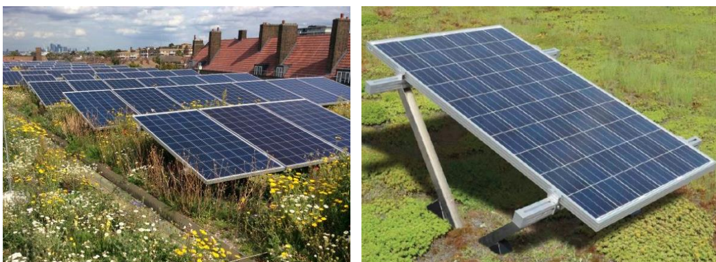
Figur 3: Solcelleanlegg på tak med intensive vekster og forhøyet monteringsystem – spesialtilpasset løsning.
