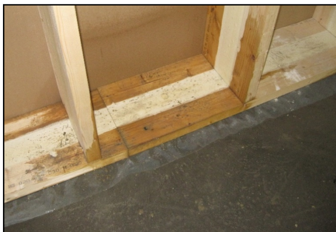
Figur 8-1: Eksempel på oppfuktet bunnsvill og vindsperre
