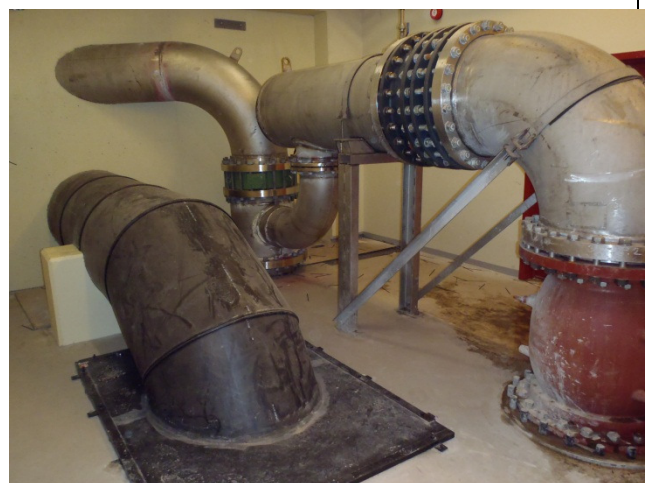
Bilde 22 – Espeland, nytt avløpsrør fra turbin (venstre) og omlegging av hovedinnløpsrør (høyre)
