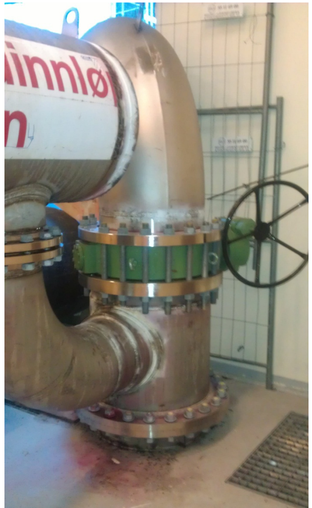
Bilde 38 – Espeland hovedinnløp/innløpsrør turbin, med ny revisjonsventil DN600
