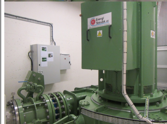
Bilde 45 –Espeland aggregat og hovedstengeventil med hydraulikkskap
