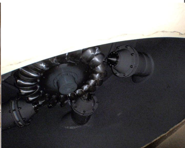
Bilde 44 – Espeland turbinløpehjul, sett fra avløpskum
