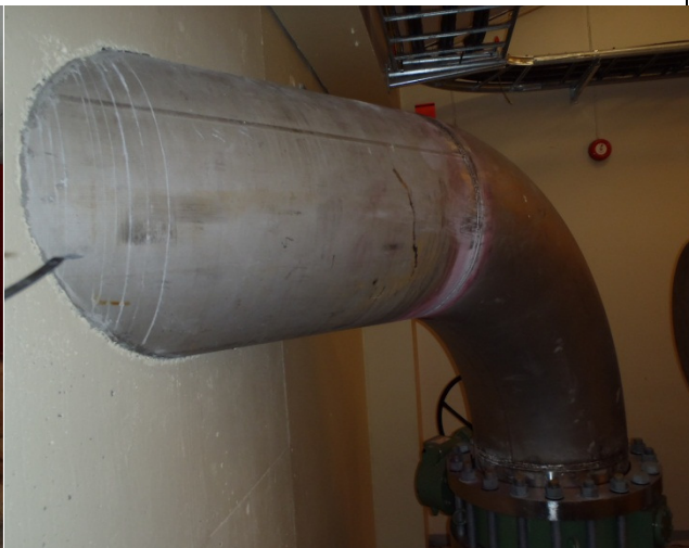
Bilde 40 – Espeland turbininnløp, veggjennomføring
