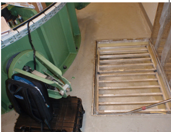
Bilde 43 –Espeland, rist over avløpskum (ved fullast)
