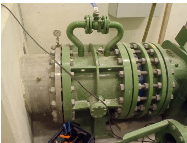
Bilde 42 – Espeland betongkloss og hovedstengeventil
