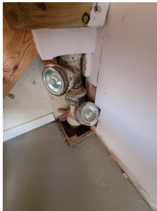
Figur 1: Støpejernsrør fra kjeller av Allanengen skole.
