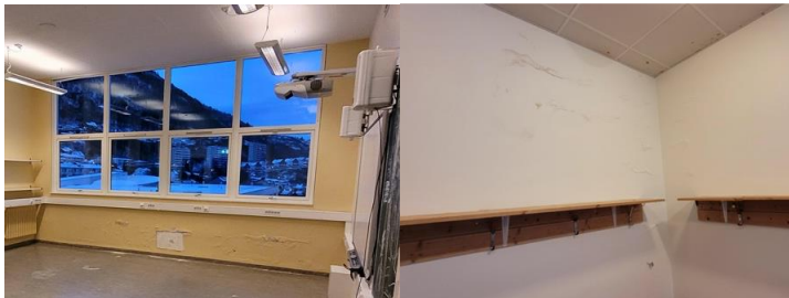
Figur 1 Saltutslag på yttervegg i Østbygget. Saltutslag på yttervegg i Vestbygget
