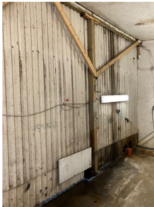
Figur 26: Det er observert trevirke (bærebjelker og søyler) som er antatt CCA-impregnert i skur ved siden av verkstedhallen.
