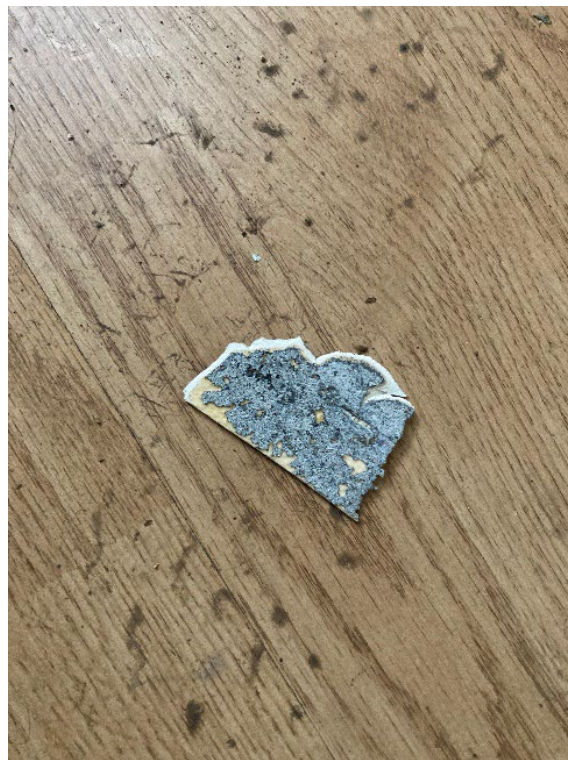
Figur 4: Lim under rødbrunt vinylbelegg (K1d) ble prøvetatt i rom K1 i kjeller. Det ble ikke påvist asbest i prøven.
