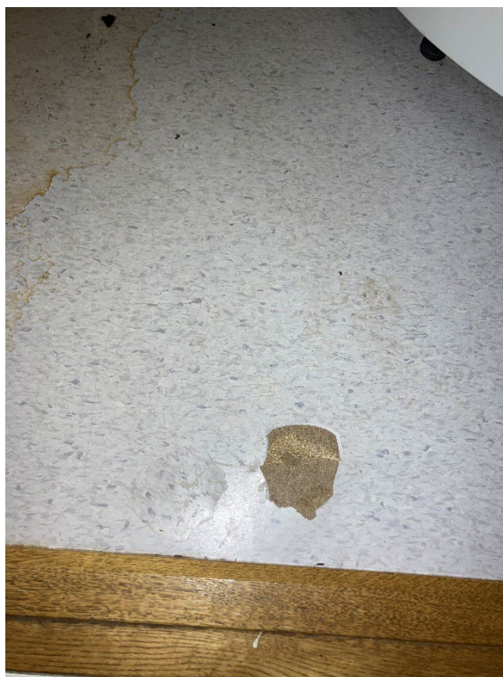
Figur 10: Hvitt vinylbelegg med går prikker (E1.6) ble prøvetatt i rom E1.6 i etasje 1. Det ble ikke påvist asbest i prøven.
