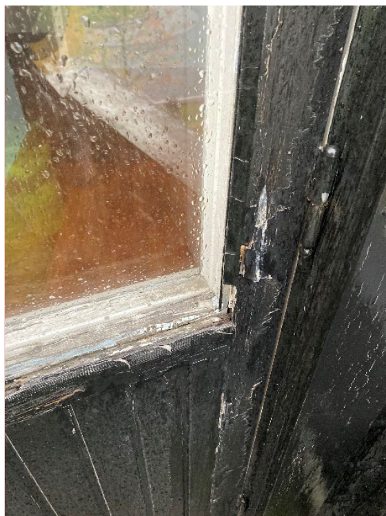
Figur 15: Kitt (E2.5) rundt glassvindu på verandadør ble prøvetatt i rom E2.5 i 2. etasje. Det ble påvist asbest i prøven.
