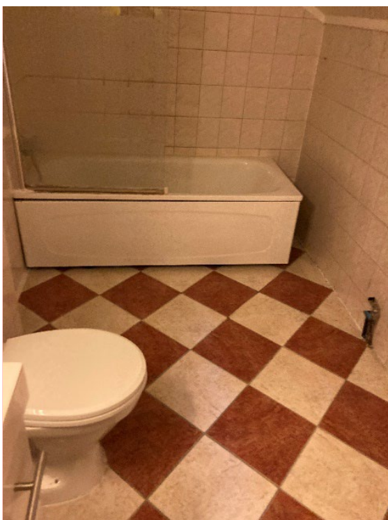
Figur 18: Gulvflis øverste lag, andre lag, og underste lag (E2.7b, E2.7e, E2.7h), lim øverste lag, andre lag, og underste lag (E2.7c, E2.7f, E2.7i), og fuge øverste lag, andre lag, og underste lag (E2.7d, E2.7g, E2.7j) ble prøvetatt i rom E2.7 i 2. etasje. Det ble påvist asbest i gulvflis (øverste lag) (E2.7b) og gulvflis (andre lag) (E2.7e).
