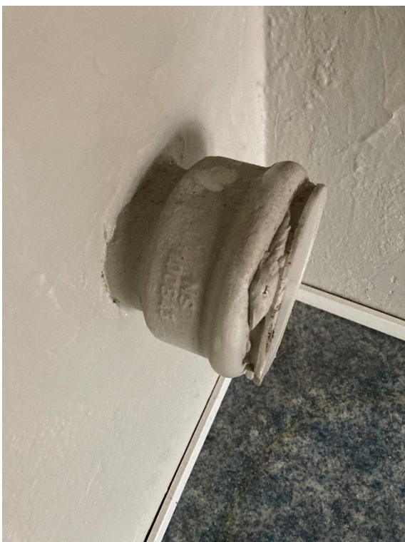
Figur 23: Det ble observert soilrør med antatt blyringer i rørsjøtet i rom E1.3 i 1. etasje.
