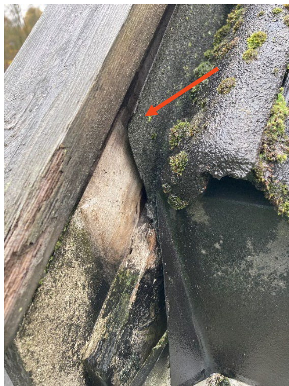
Figur 21: Takpapp (T2) ble prøvetatt utendørs på balkong/tak. Det ble ikke påvist asbest i prøven.
