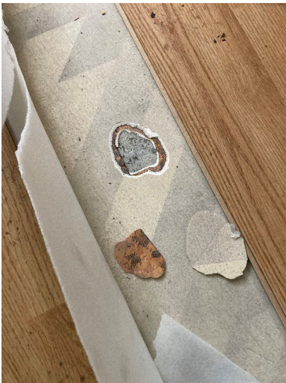
Figur 3: Beige vinylbelegg (K1c) og rødbrunt vinylbelegg (K1e) ble prøvetatt i rom K1 i kjeller. Det ble ikke påvist asbest i prøvene.
