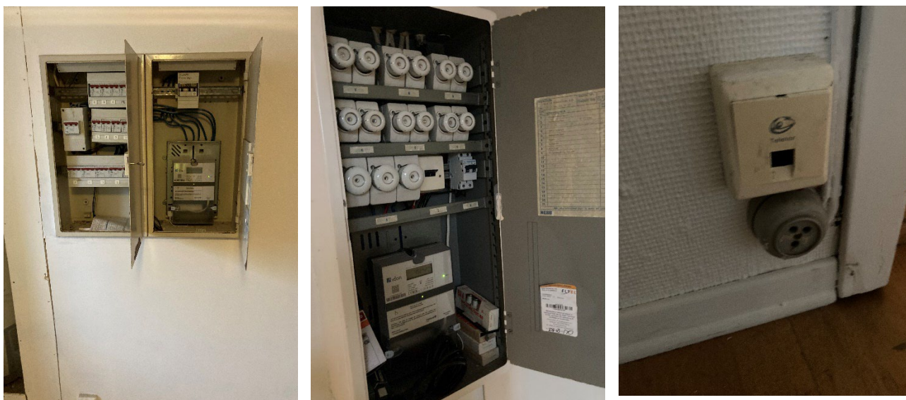
Figur 24: Eksempel på EE-avfall observert i ulike rom i bygningen. Bildet i midten og til høyre viser bakelitt som er antatt asbestholdig.
