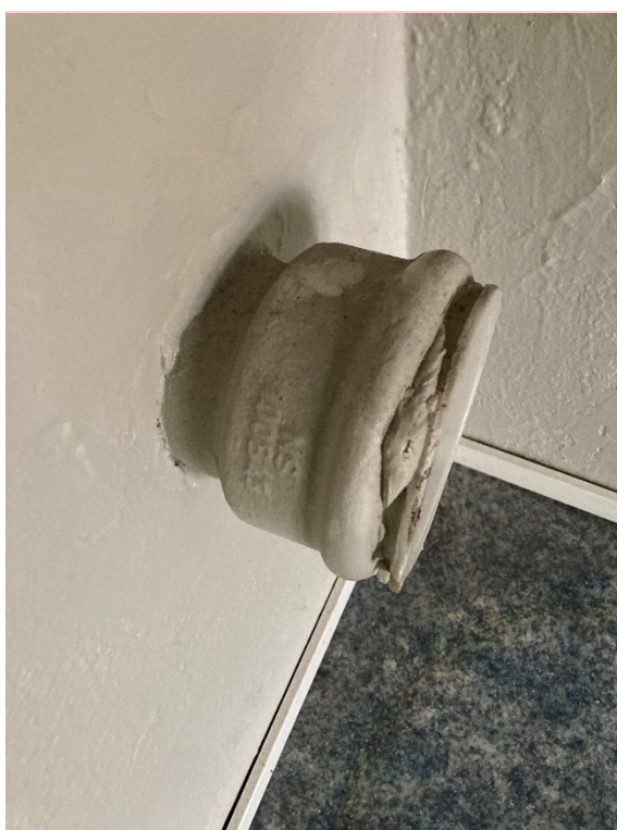
Figur 22: Soilrør med antatt asbesttråd i skjøten ble observert i rom E1.3 i 1. etasje.
