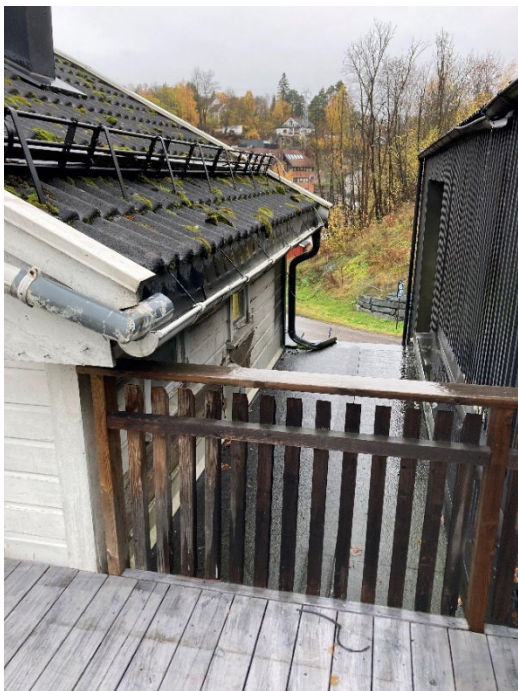
Figur 25: Det er observert trevirke (platting og rekkverk) som er antatt CCA-impregnert på balkong/tak mellom kontor/boligbygg og verkstedhall.
