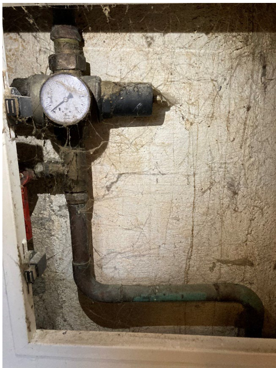
Figur 28: Antatt kvikksølvholdig trykkmåler ble observert i rom K4 i kjeller.
