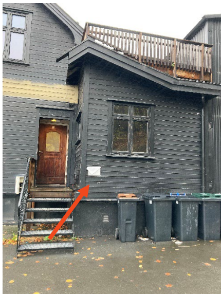
Figur 29: Svart maling (U1) ble prøvetatt på yttervegg av kontorbygget.
