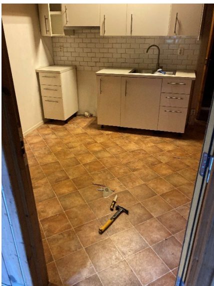
Figur 12: Brunt/rødt vinylbelegg (flisimitasjon) (E1.8) ble prøvetatt i rom E1.8 i etasje 1. Det ble ikke påvist asbest i prøven.
