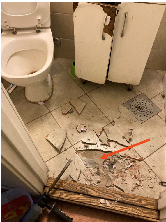
Figur 7: Avretting under flis (K7) ble prøvetatt i rom K7 i kjeller. Det ble ikke påvist asbest i prøven.
