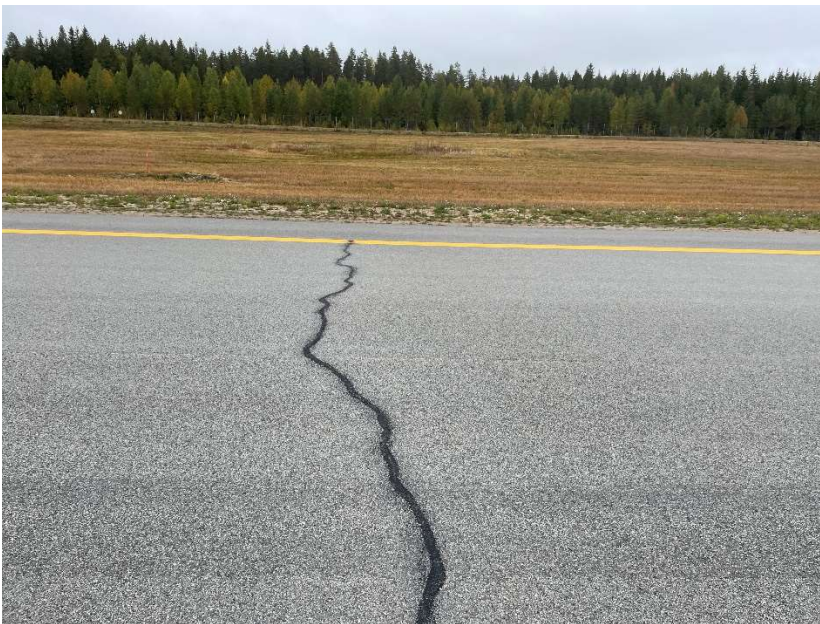
Bilde 6 Tverrgående sprekk rullebane
