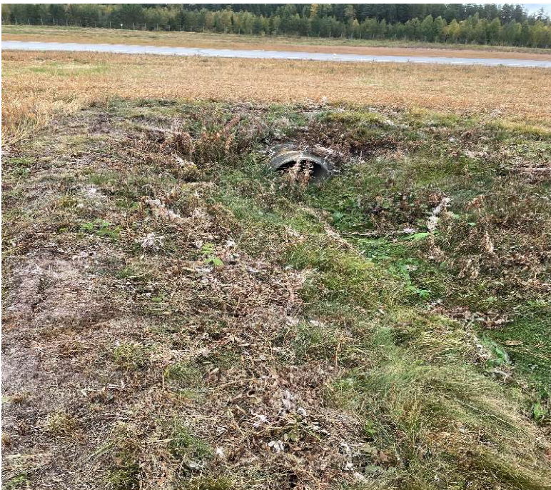
Bilde 13 OV-ledning (betong-rør) som krysser RWY, som må kontrolleres og eventuelt utbedres.
