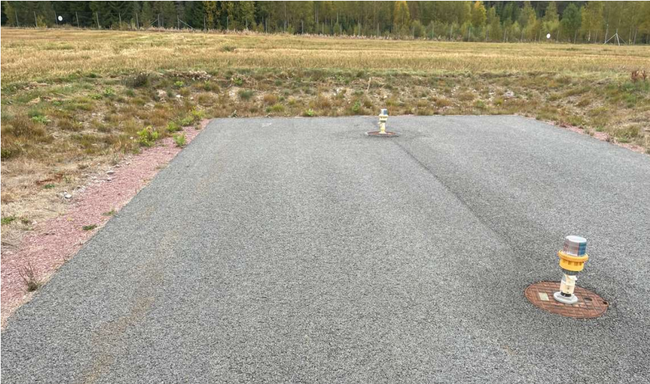
Bilde 14 Terskel øst Bane 30 Viser for bratt terreng inn mot asfalt.
