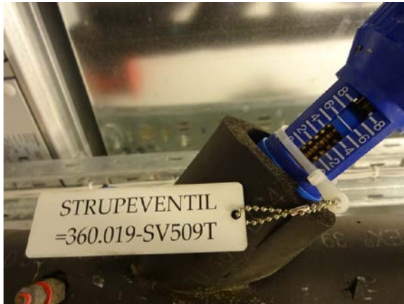
Eksempel på merking av ventil. SV er komponentkode for strupeventil.
