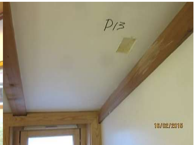
Bilde 10: Prøve 13, overmalt himlingsplate. Prøve viser ikke innhold av asbest.
