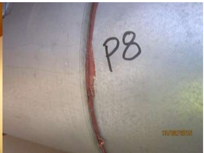
Bilde 14: Prøve 8 av brunfarget fugemasse ved skjøt på eldre ventilasjonskanal viser innhold av asbest.
