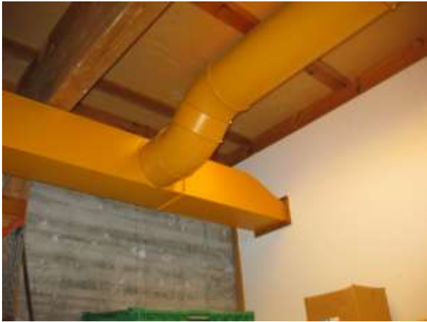
Bilde 20: Prøve 15. maling på kanaler inneholder bly. Og fuge i kanalskjøter inneholder asbest. Kanaler saneres, leveres som farlig avfall.
