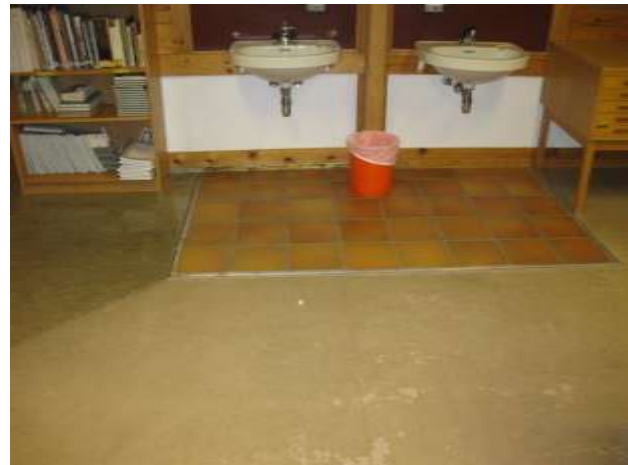
Bilde 23: Belegg av linoleum mot våtsone med flis. To farger samme type belegg. Forurenset avfall.
