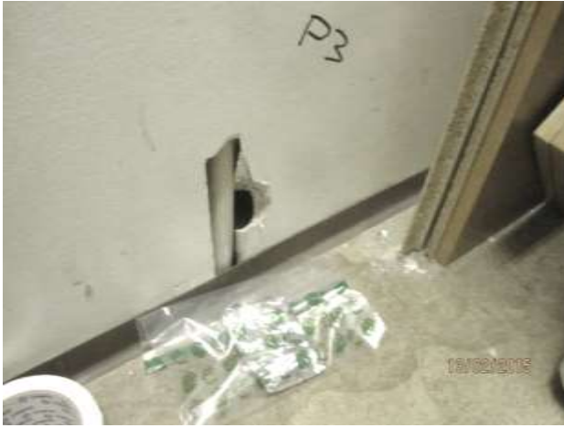
Bilde 7: Prøve 3 av veggplater viser innhold av asbest.
