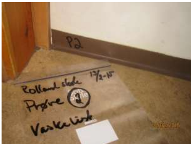
Bilde 26: Prøve 01 av vaskelister. Inneholder ftalater over grensen for farlig avfall.
