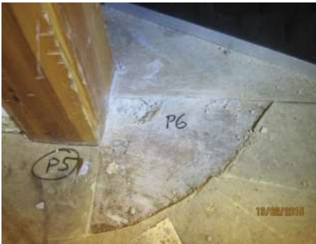
Bilde 15: Prøve P4 og P6 under belegget. Ikke påvist asbest
