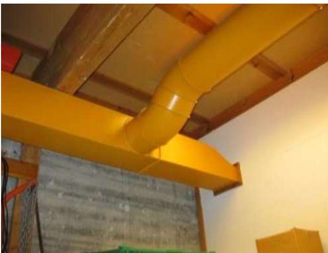
Bilde 13: Typisk rund og firkant kanal i undervisningsrom/grupperom som er malt. Brun fugemasse som inneholder asbest.
