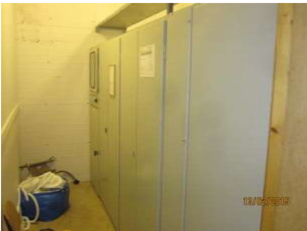
Bilde 32: Tavlerom 103. Hovedtavle EE-avfall
