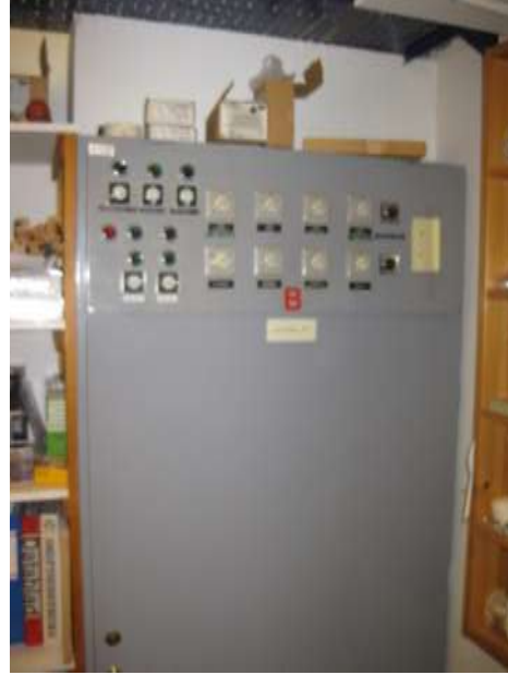
Bilde 29: Fordelerskap , 4-5stk. underfordelings skap påvist i korridor.
