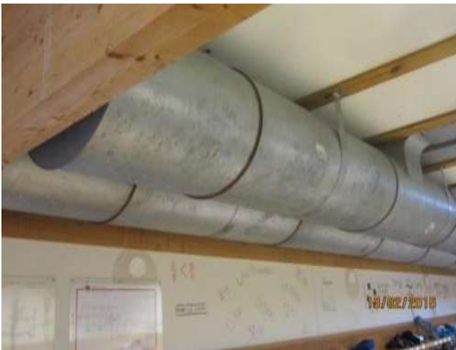
Bilde 11: Typisk rund kanal i undervisningsrom/grupperom. Brun fugemasse som inneholder asbest.
