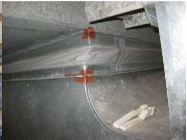
Bilde 12: Viser skjøter/pakning på kanaler mot aggregat på ventilasjonsloft. Brun fugemasse som inneholder asbest.
