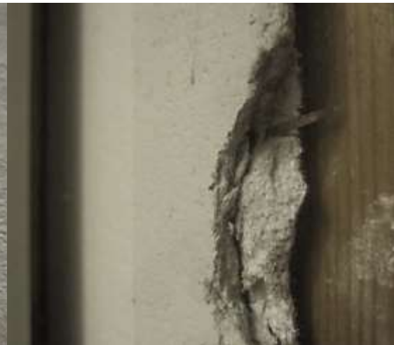
Bilde 6: Viser kant på veggplater i tavlerom 103. Ubehandlet pernit plater.
