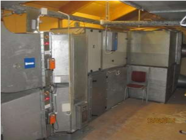
Bilde 30: Ventilasjonsaggregat. EE-avfall
