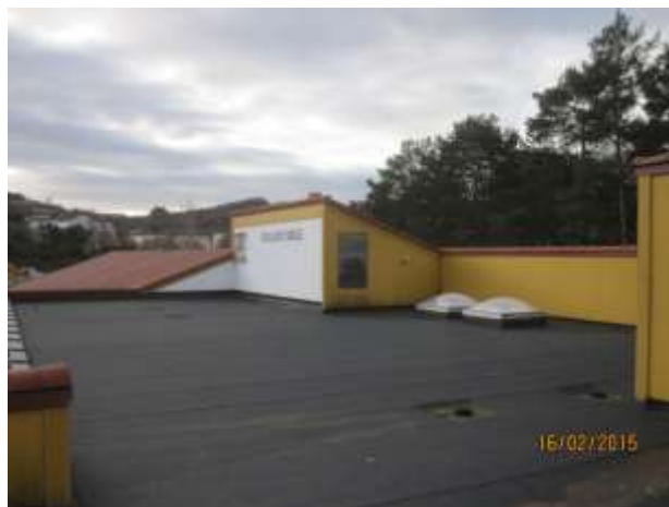
Bilde 36: Prøve 16, Mulig eldre papp under ny tekking, inneholder PAH over normverdi.
