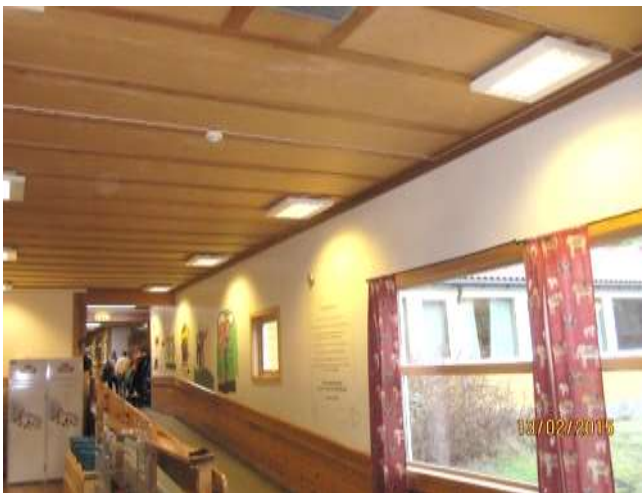
Bilde 9: Typisk himlinger av gipsplater. Prøve viser ikke innhold av asbest.
