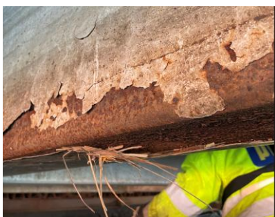
Bilde 4: Stålbjelke med korrosjon der overflatebehandlingen er borte - bilde tatt under Norconsult befaring april 2023
