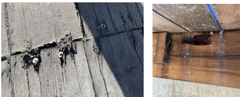
Bilde 3: Råteskader fotografert under Norconsults befaring april 2024
