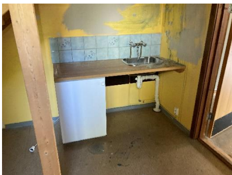
Figur 2: keramiske fliser over vask. Rom nr. 117 gang.
