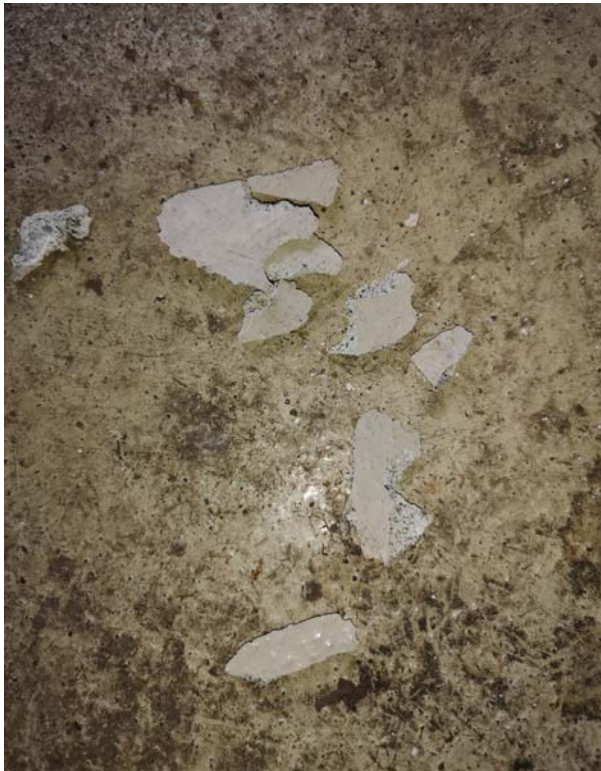
Figur 21: Epoxybelegg på gulv i verksted. Prøve P16 ble tatt av belegget. Det ble ikke påvist tungmetaller, PCB eller asbest som klassifiserer belegget som farlig avfall.
