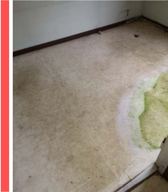
Figur 19: Vinylbelegg på gulv i første etasje i kontordel. Vinylbelegget inneholder erfaringsmessig ftalater over grensen for farlig avfall.
