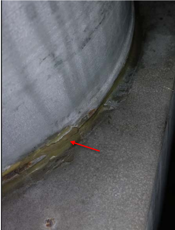
Figur 15: Fuge-/tette masse på skjøt på ventilasjonsrør i ventilasjonsrom. Fugen/tette massen inneholder ikke asbest.
