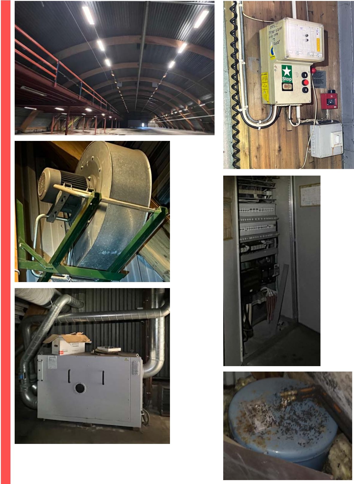
Figur 27: Eksempler på EE-avfall i bygningen.
