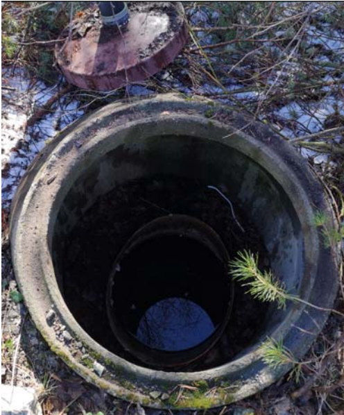
Figur 9: Bilde av slamavskiller like sør for lagerhallen. Foto: Multiconsult.
