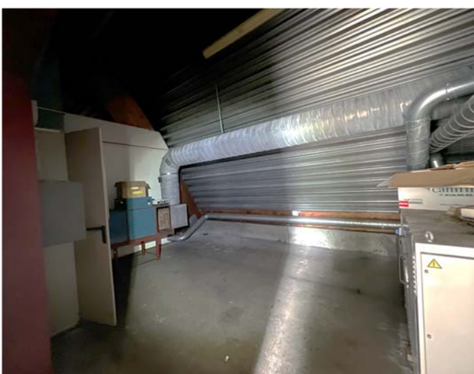
Figur 7: Innvendig i ventilasjonsrommet. Foto: Multiconsult.
