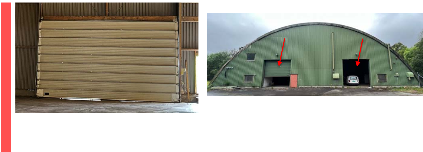
Figur 26: Isolerte leddporter i lagerhallen. Leddportene leveres hele til godkjent mottak som farlig avfall.
