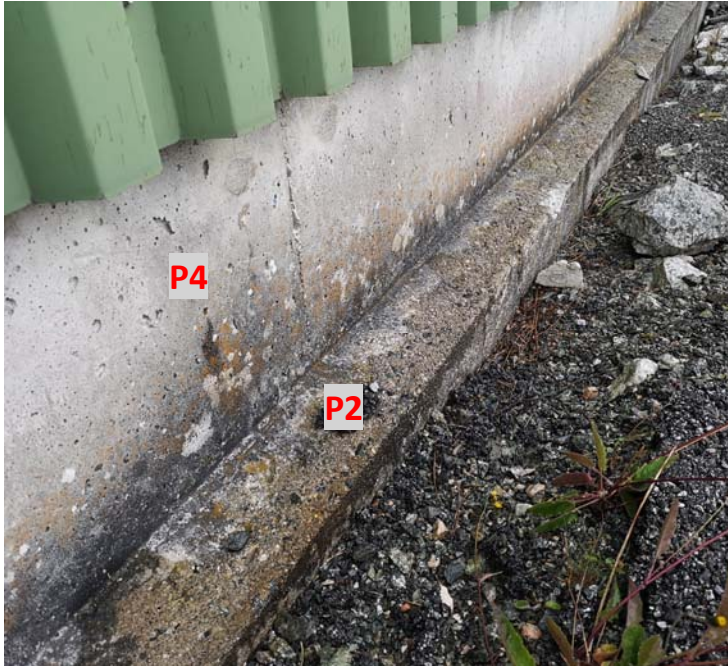
Figur 28: Bilde av fundamentet til grunnmuren, og grunnmuren. Prøve P2 og P4 ble tatt av betongkonstruksjonene.
