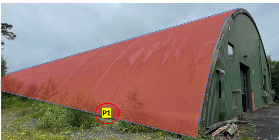
Figur 10: Foto med prøvetakingspunkt (P1) og registrering av farlig avfall (takduk) på taket til lagerhallen. Foto: Multiconsult.
