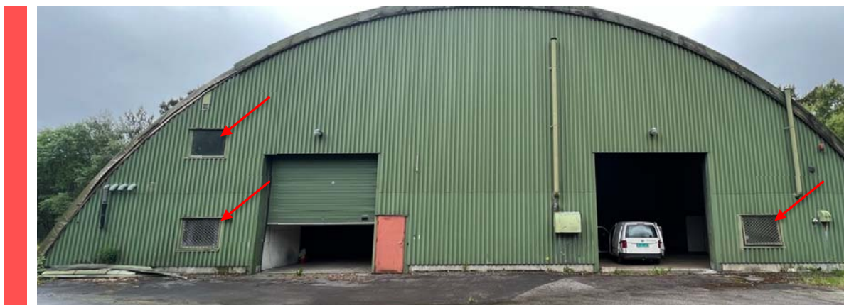
Figur 16: Isolerglassruter med innhold av klorparafiner. Foto: Multiconsult.
