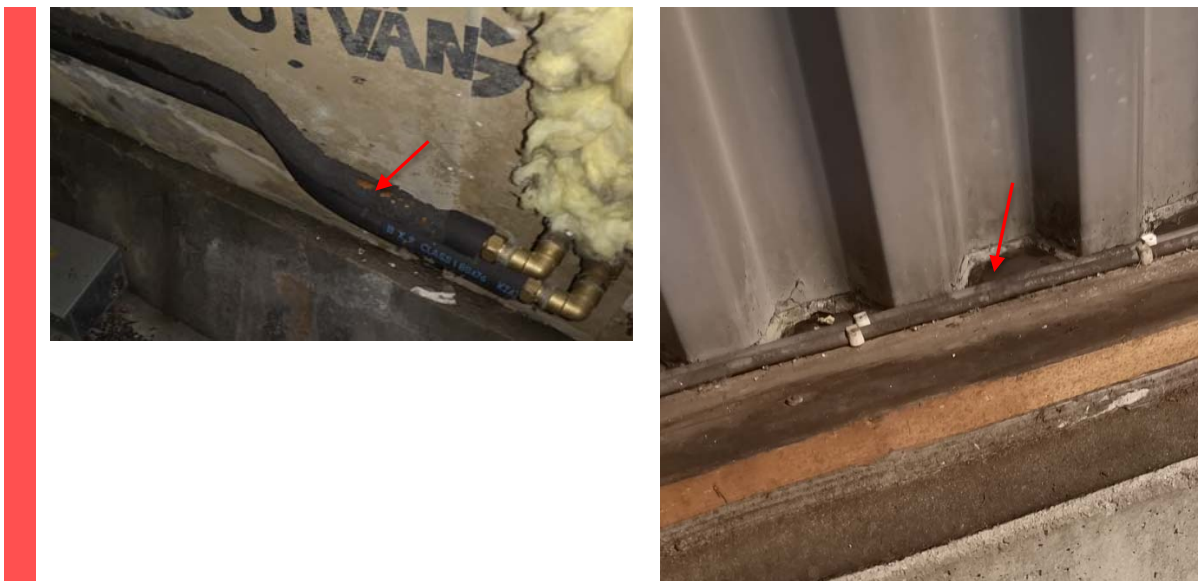
Figur 25: Cellegummi som isolasjon rundt rør (venstre bilde), og mellom stålplater i fasade og grunnmur (høyre bilde). Cellegummien inneholder bromerte flammehemmere over grensen for farlig avfall, og skal leveres til godkjent mottak for farlig avfall.
