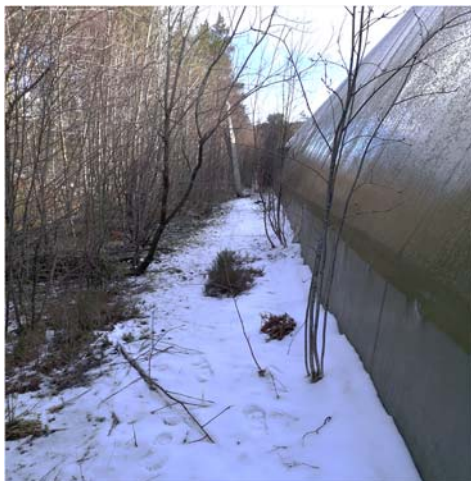
Figur 10: Prøvetakingspunkt P6 ble tatt som en blandeprøve av massene ned til 0,2 m dybde langs nord-fasaden på COB-hallen. Foto er tatt mot nordøst. Foto: Multiconsult.
