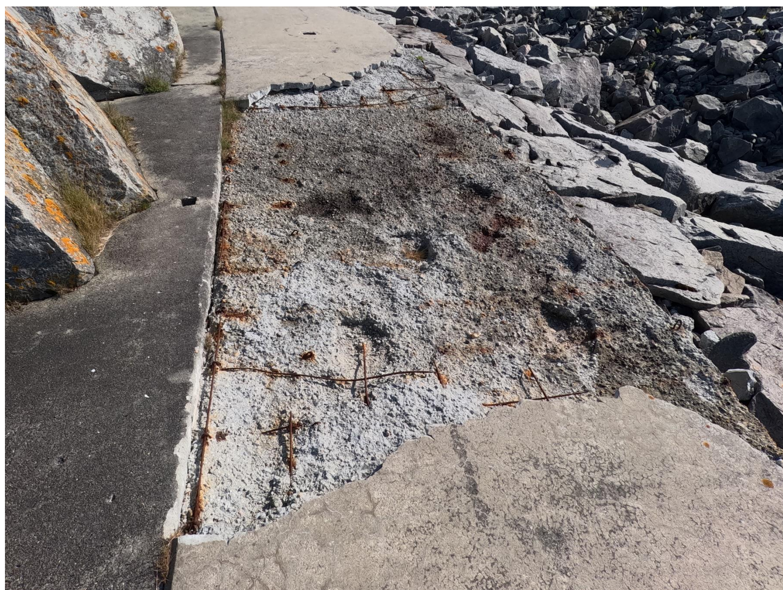
Figur 18: Skader på betongdekket.
