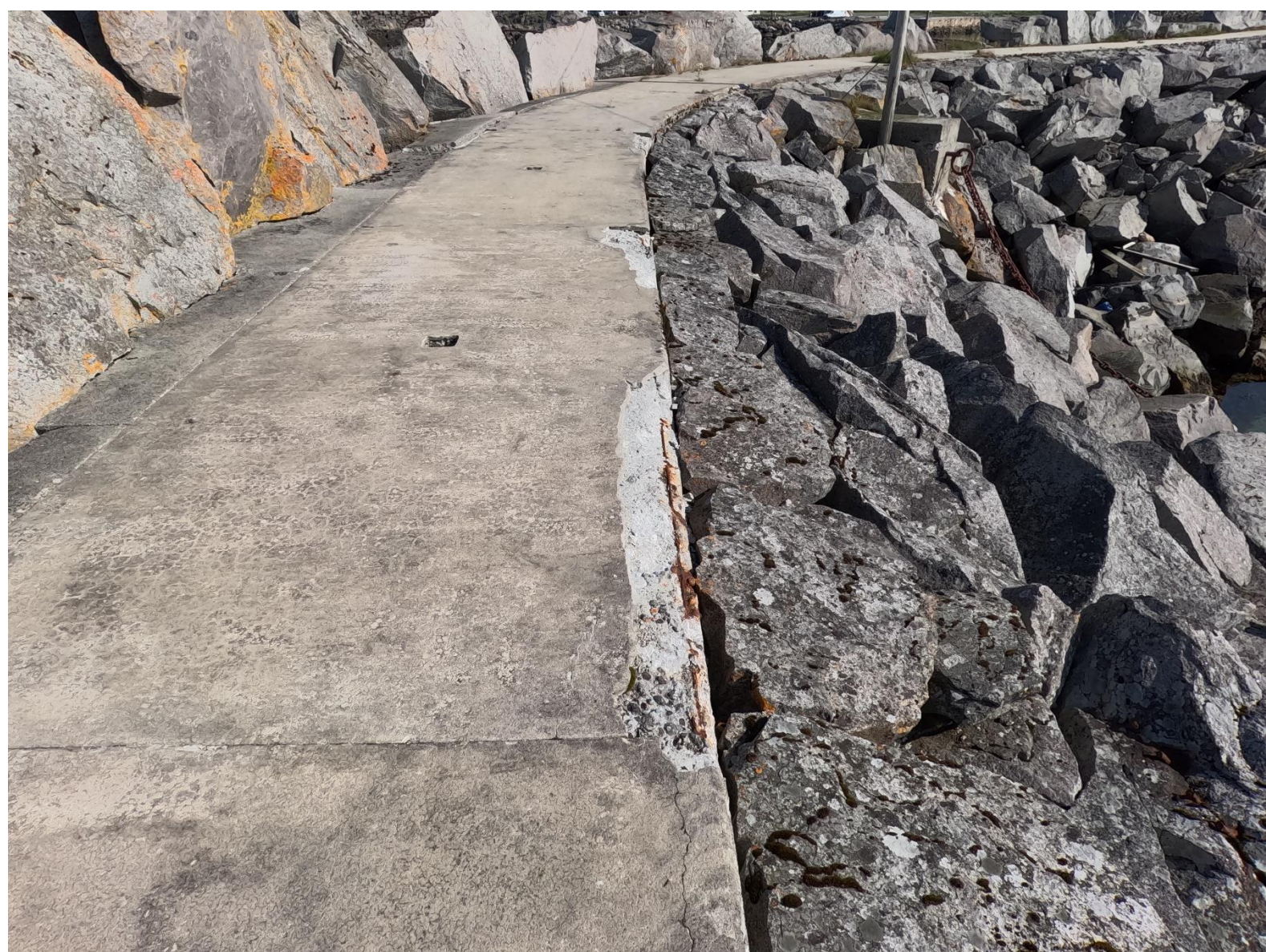
Figur 17: Slitasje på dekket.
