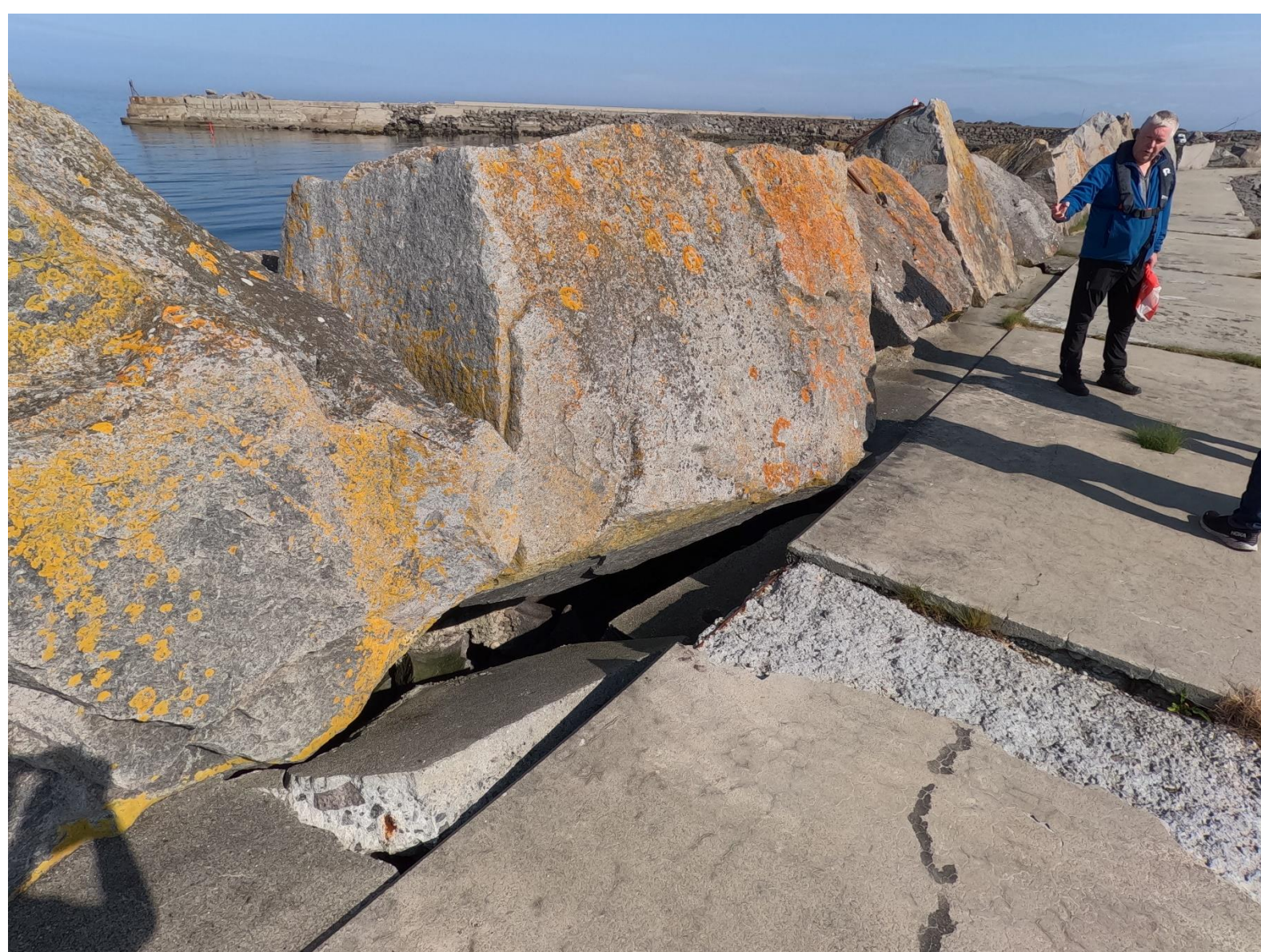
Figur 4: Hulrom kommer opp bak brystvern.
