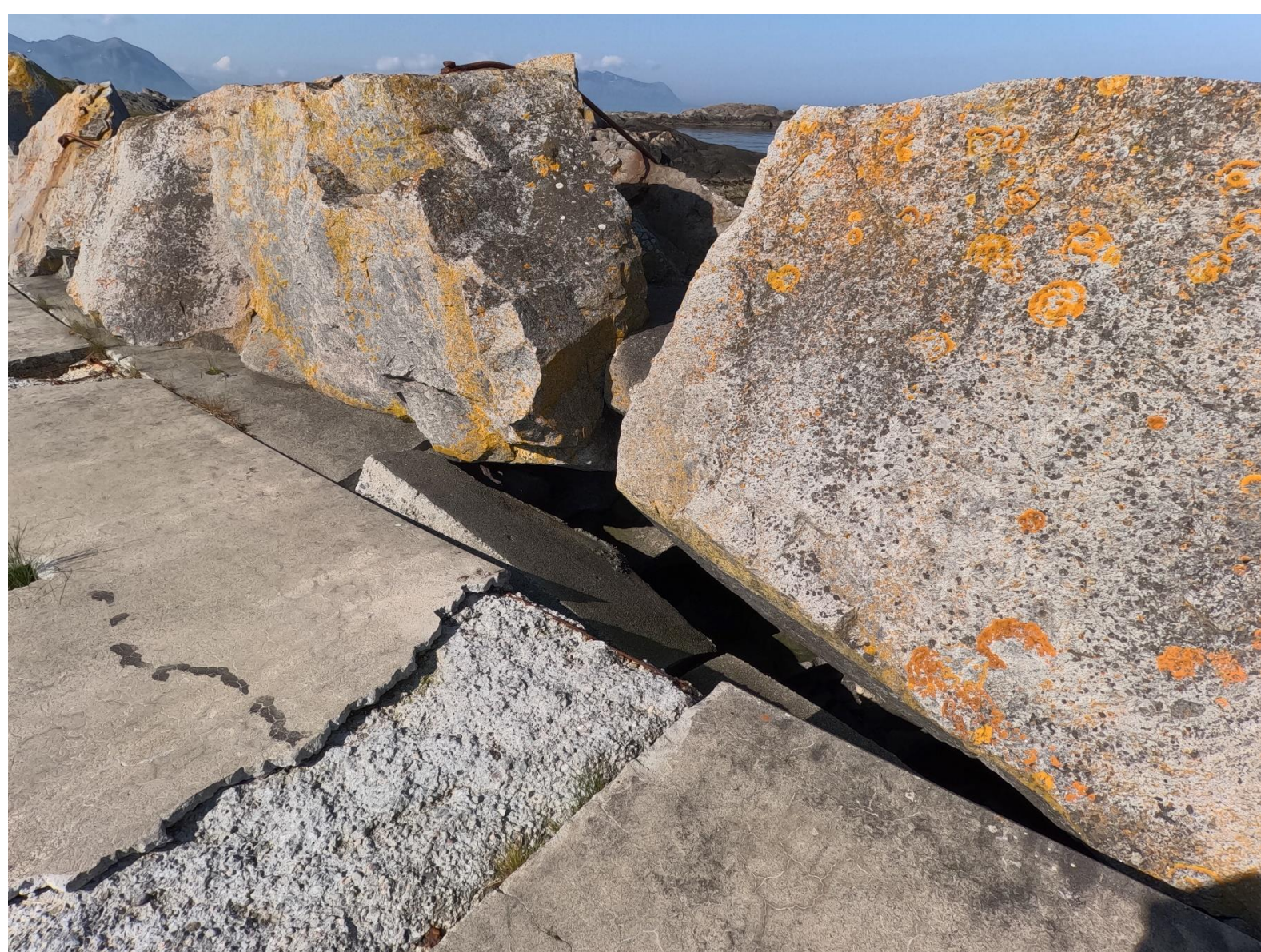
Figur 3: Hulrom kommer opp bak brystvern.
