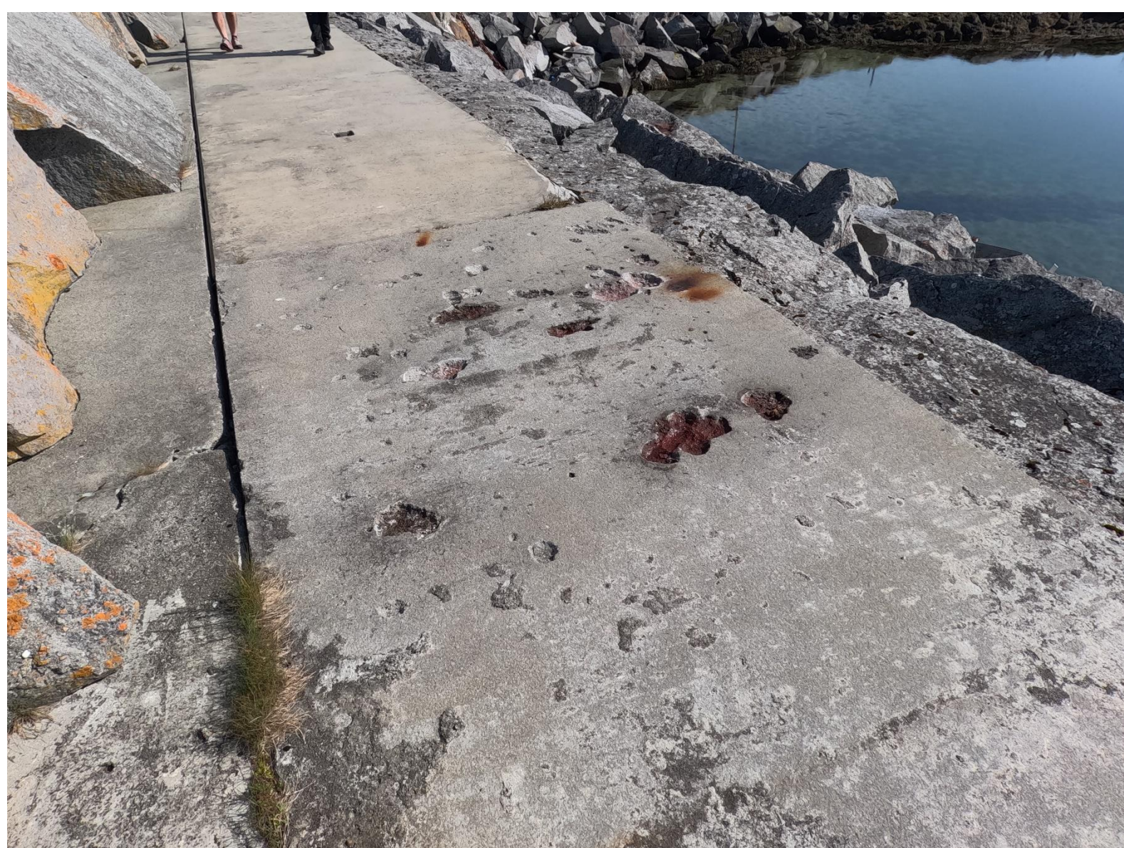
Figur 20: Skader på betongdekket.
