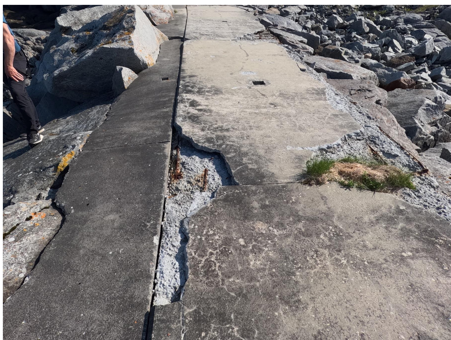
Figur 10: Skader på betongdekket.
