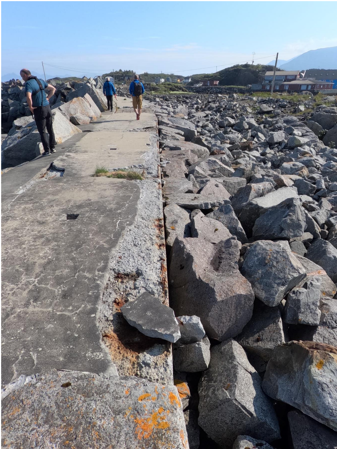
Figur 11: Skader på betongdekket.
