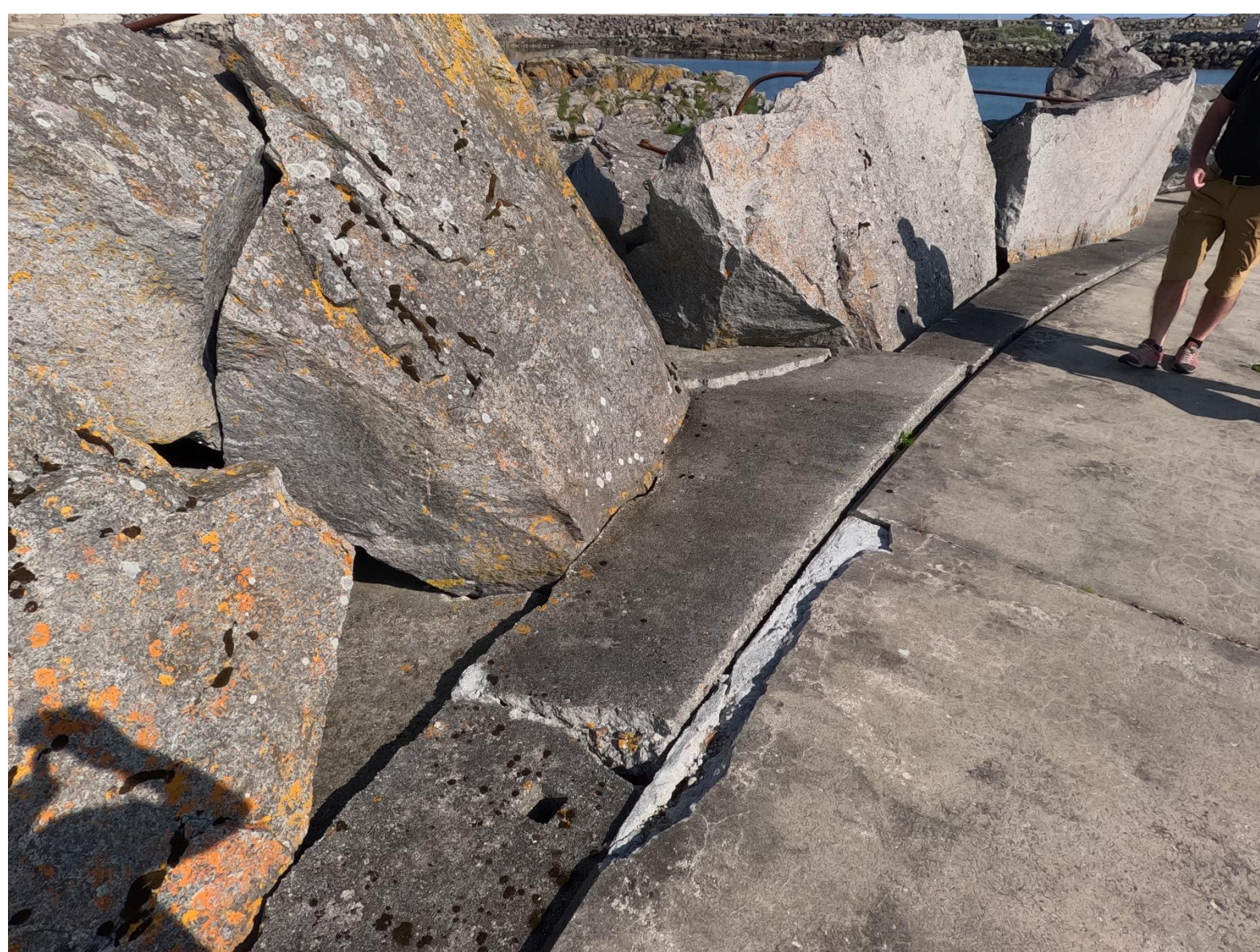
Figur 12: Noe sig i betongdekket.
