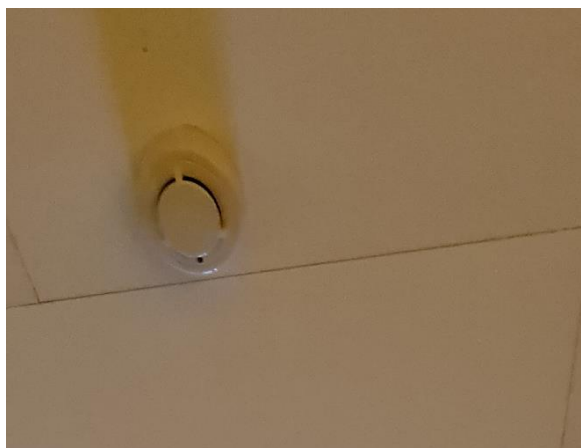
Bilde 16: Brannvarsel i bygget.
