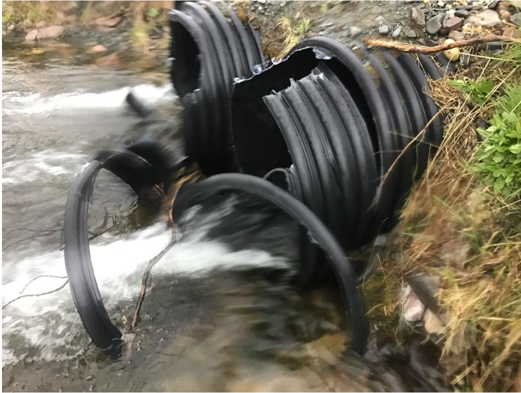
Figur 5. Skader på rør nedside ved utløp i kulp.
