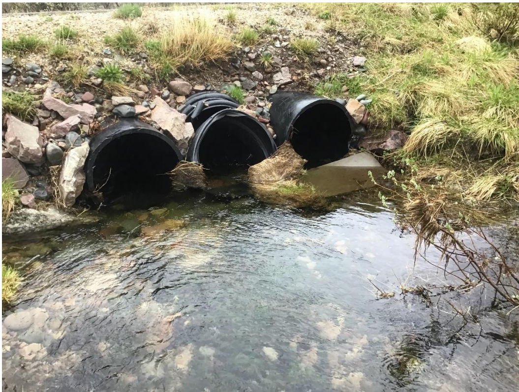
Figur 4. Rør sett fra oversiden. Også her er det skader. Rør ligger ca. 20 cm over bekkebunn. Røras plassering lager en mindre terskel som gir en liten oppstuvning av vann oppstrøms.
