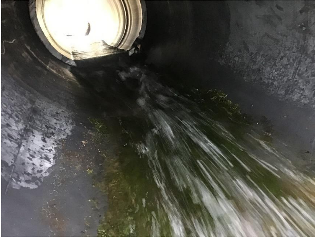
Figur 3. Uheldig detalj i rørene, sett fra nedsiden. Skjõt/overgang til rør med mindre diameter som lager lite trinn/kant. Bildet viser at det til og med under høy vannføring er liten vanndybde for å fisken å svømme i. Strømshastigheten er relativt høy, men dette er ingen hindring i seg selv siden svømmeavstanden er kort og tilgangen inn i rør er ok (ved høy vannføring).
