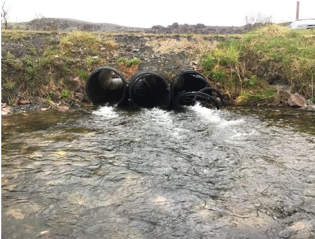
Figur 2. Rør og kulp nedstrøms veien. Rør er skadet. Ved høy vannføring som på bildet flukter vannspeil i kulp med vannspeil i rør og adkomst inn i rør er uproblematisk. Vanddybde i rør var relativt lav ved høy vannføring, og vanddybden i rør vil være flaskehalsen ved lavere vannføringer (som dominerer). Midtre rør hadde 17 cm vanddyb på befaringen, og nest dypeste hadde 10 cm.
