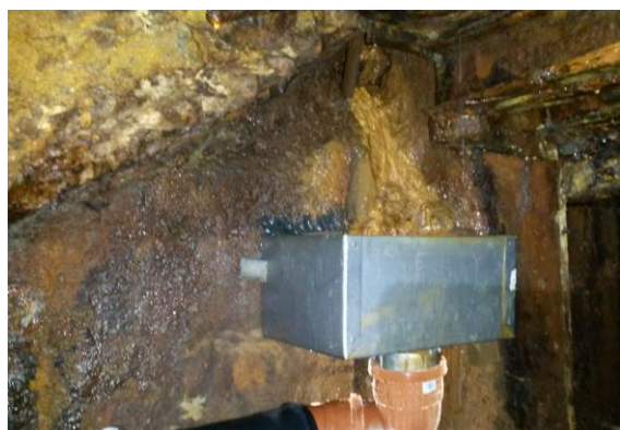
Figur 2. Oppsamling av takvann i nord
