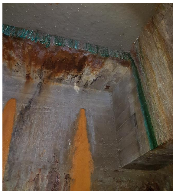
Figur 3: Innsig av forurenset vann fra vegg og tak til tunnel (tunnelvann)
