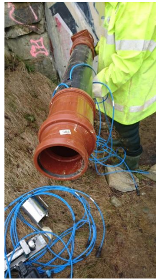
Figur 4: Sensor montert i rør.
