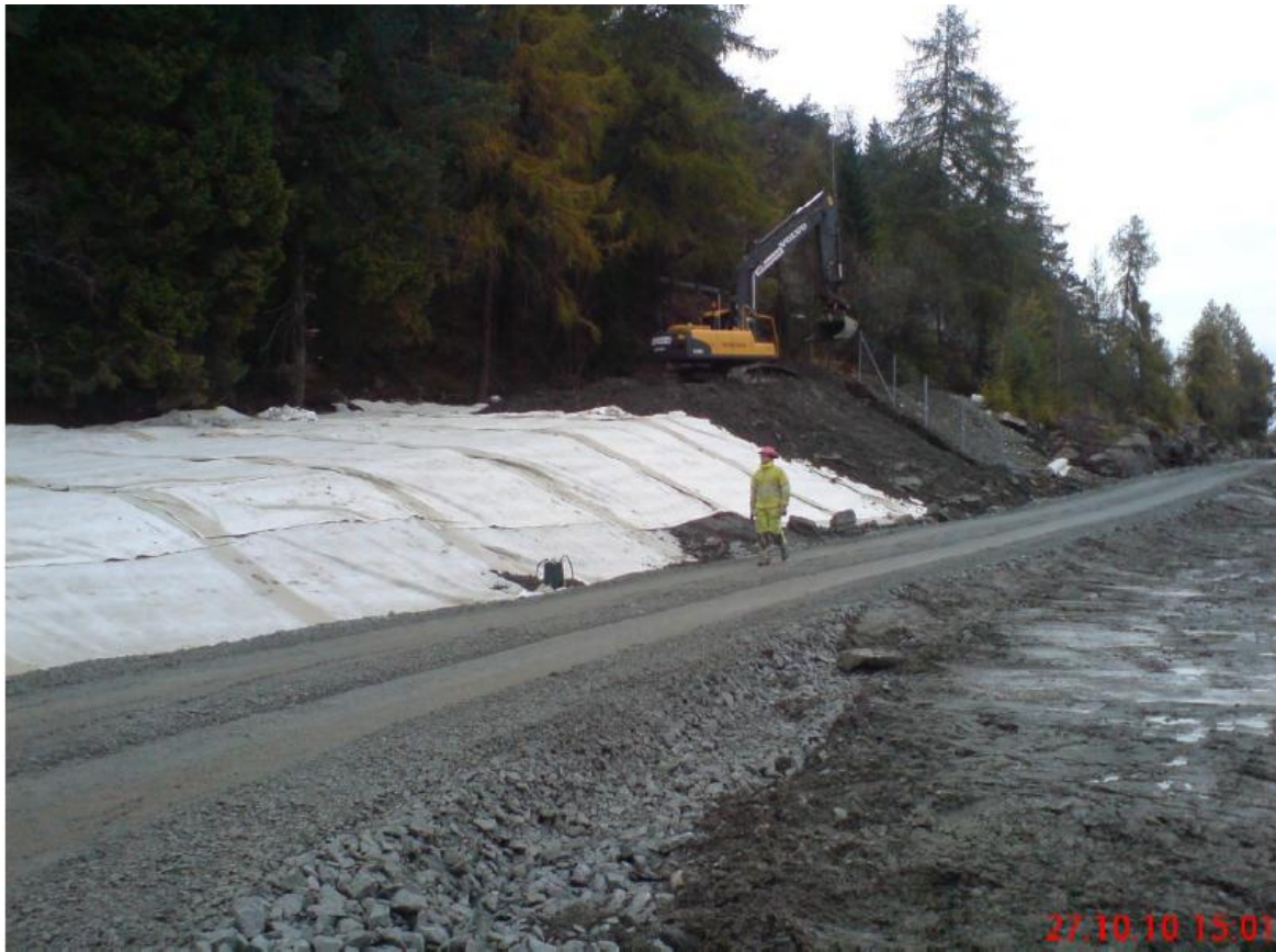
Figur 19 Utlegging av masser over membran (MC 27.10.2010). Hvordan er avslutning mot gang og sykkelvei?
