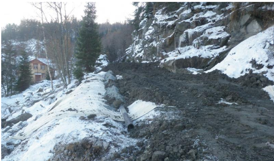
Figur 18 Legging av membran, drenering og overfylling, i lossesporet helt sør på området (MC 18.11.2010)
