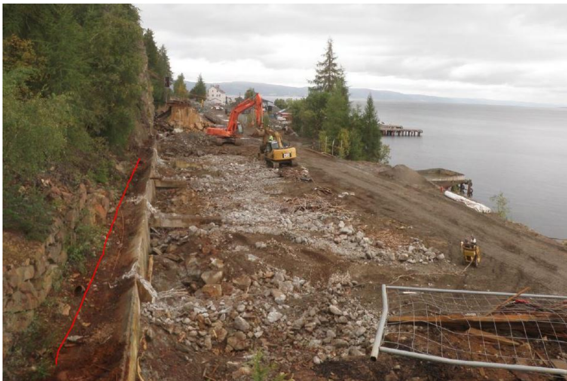
Figur 12 Murt betonggrøft der drensør for overflatevann ble lagt, nordre del t.v., søndre del t.h.
