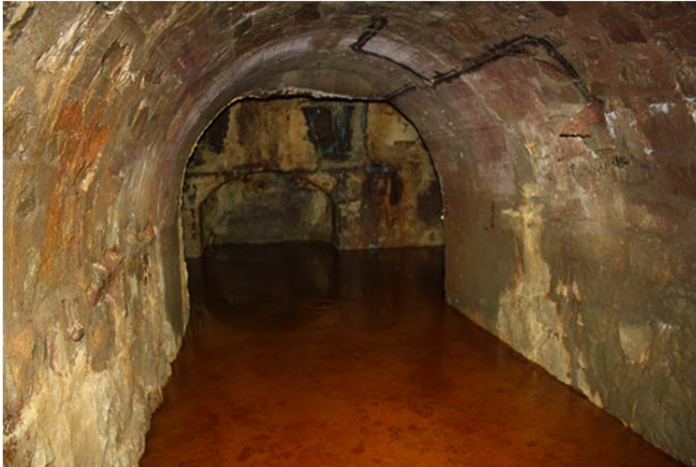
Figur 9 Dam i vestre (indre) del av adkomsttunnel. Ca. ved prøvepunkt V10.
