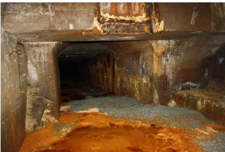
Figur 11 Mindre vann i tunnelen sør for adkomsten (retning V4). Men singelen i bunnen av tunnelen er også her mettet med rustfarget vann (mektighet ca. 20-25 cm).
