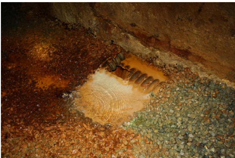
Figur 13 Prøvested V11-1 og V11-4. Vann står opp til toppen av drensrøret, fordi slissene et gått tett av utfelt materiale. Toppen av røret er skåret av, for inspeksjon og prøvetaking inni røret.
