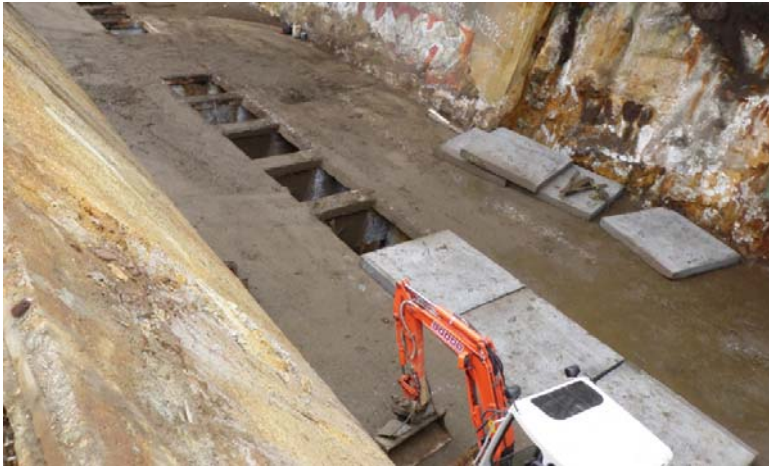
Figur 12 Foto fra saneringsfasen i 2010, som viser betongelementer benyttet for tetting av luker i golvet i lagerhallen. Undersiden av et slikt betongelement er vist i Figur 14.
