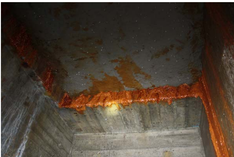
Figur 14 Innsig fra tunneltaket, gjennom en av golvlukene i lagerhallen.
