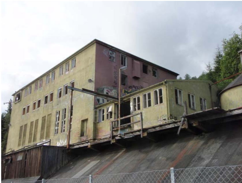
Figur 10 Oppredningsbygget, sett fra nordøst. Deler av bygningen med knuseverket i høyre billedkant, og taket over lossesjaktene i forkant.
