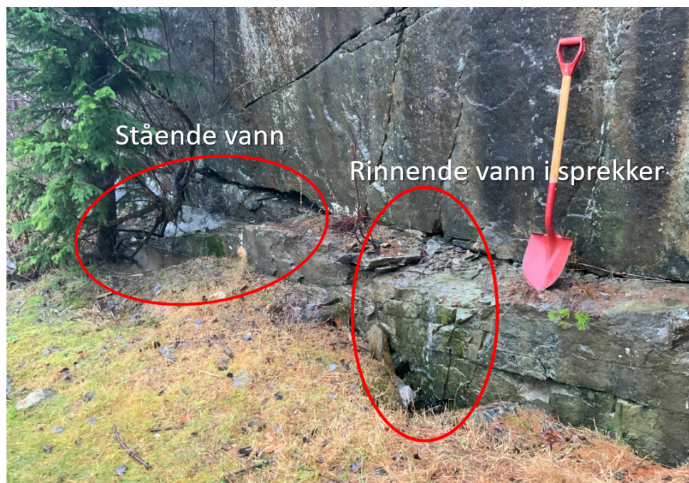
Figur 10 Stående vann og rennende vann i sprekker sør på området i bakkant av deponiet. Registrert på befaringen 24. november 2021.
