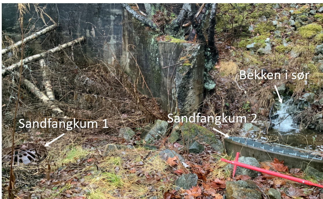
Figur 9 Sandfangkummene til bekken i sør var begge i overløp på befaringen 24. november 2021.
