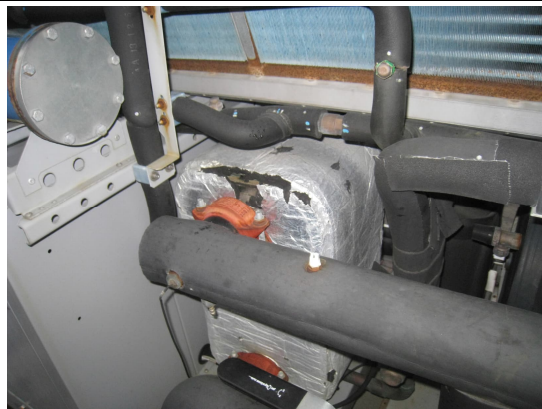
Skade på isolasjon
