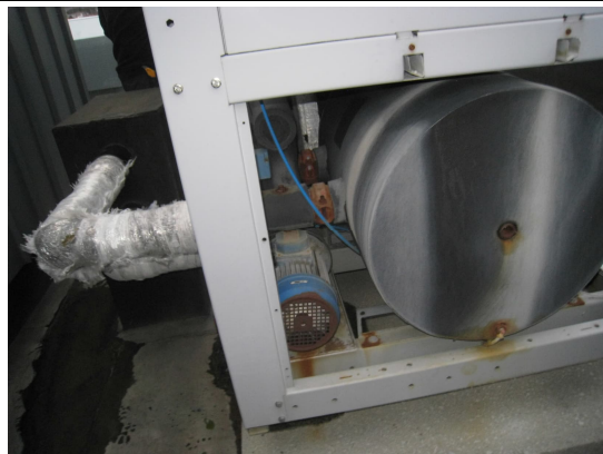
Rust og skader på isolasjon
