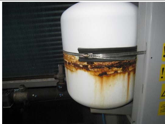
Rust på ekspansjonskar
