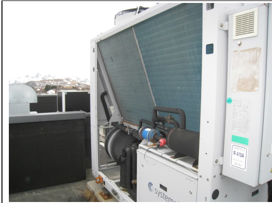
Skader på varmepumpe.
