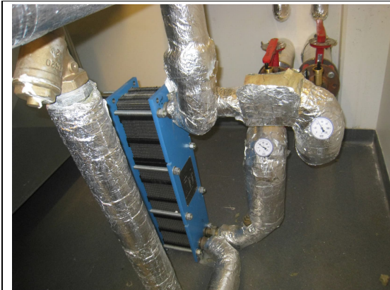
Varmeveksler mellom hovedanlegg og glykolkurs
