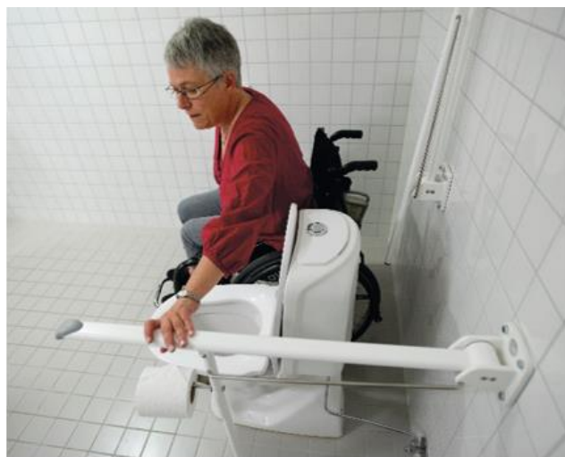
Veggmontert toalett med støttehåndtak montert på vegg og gulvplass på 20 cm fra vegg til bakre cisternekant, som gjør sideveis forflytting fra rullestol enklere og gir plass til hjelpers fot. Det mangler kontrast mellom utstyr og vegg og mellom gulv og vegg. Kilde: Toalett og bad. Detaljer som teller. Norges Handikapforbund. Foto: Marit Hommeland
