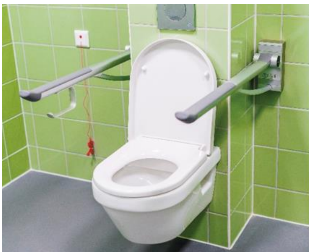
Veggmontert toalett med støttehåndtak montert på vegg. Kilde: Tilgjengelige bygg og uteområder, Norges Handikapforbund. Foto: Tore Fjell.
