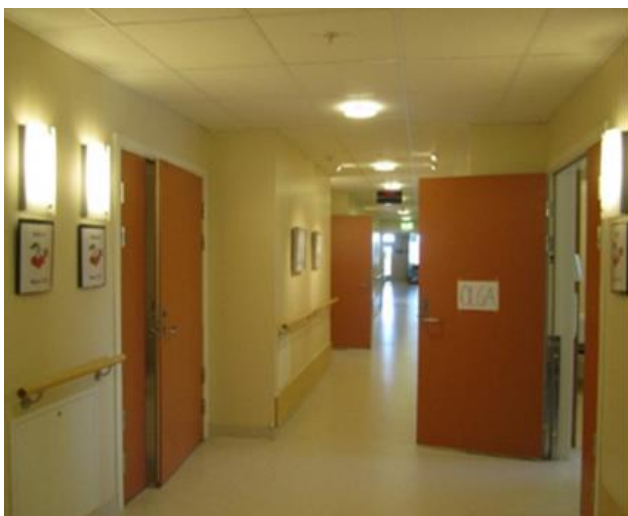
Inngangsdører til boenheter kommer i veien for passerende i korridor. Foto: Husbanken
