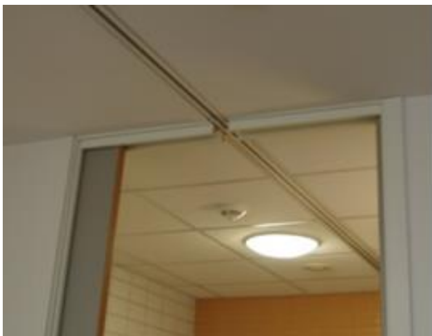
Det finnes løsninger hvor skinnen kan felles inn i takhimlingen. Skinnene blir da svært diskrete når de ikke er i bruk. Foto: Karin Høyland
