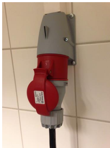
Eksempel fastmontert 400V 3-fas.
