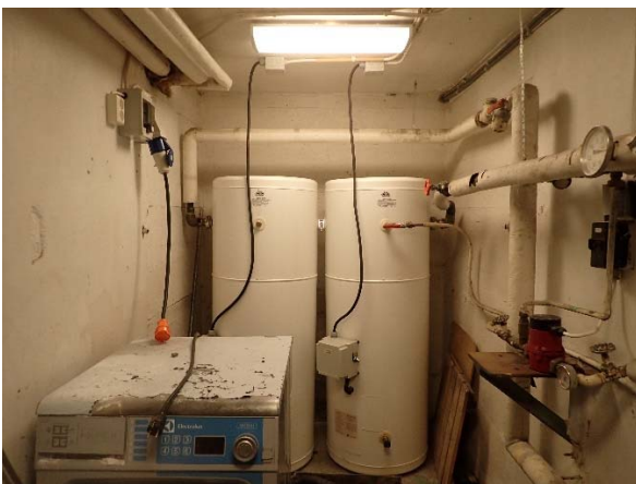
Figur 11 Teknisk rom i opprinnelig del.
