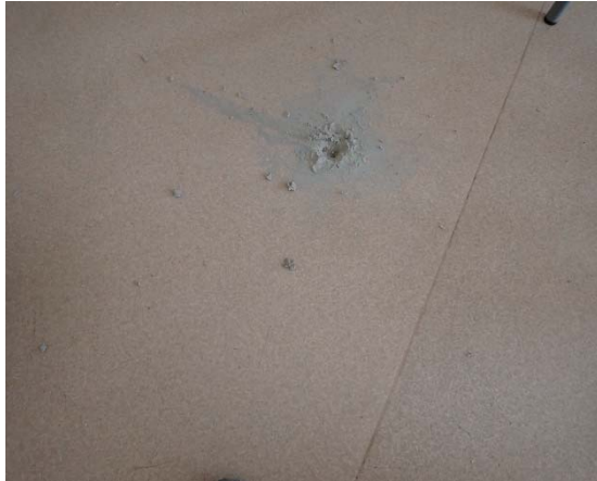
Figur 15 Betongdekke i 2. et., prøve P40.
