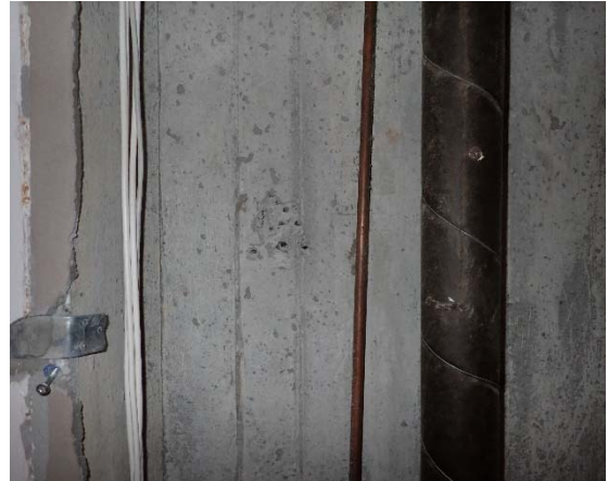
Figur 16 Betongsøyle i del fra 1966, prøve P33.
