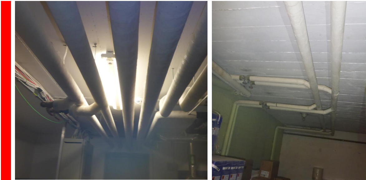
Figur 12 T.v. Registrerte rørføringer i tak i rom 008/vifterom. T.h. Registrerte rørføringer i taket i rom 018/depot mob.lager. Samtlige rørbend og endekapper antas å være asbestholdige.
