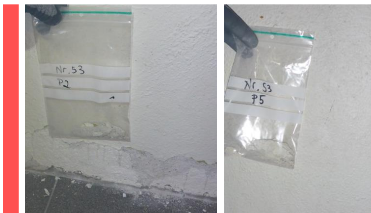
Figur 22 T.v. Veggmalings ( P2 ) i rom 002/tørkerom, kaserne 53 T.h. Veggmalings ( P5 ) i rom 012/trapperom, kaserne 53. Det er påvist innhold av sink over grenseverdi for farlig avfall i begge prøvene.
