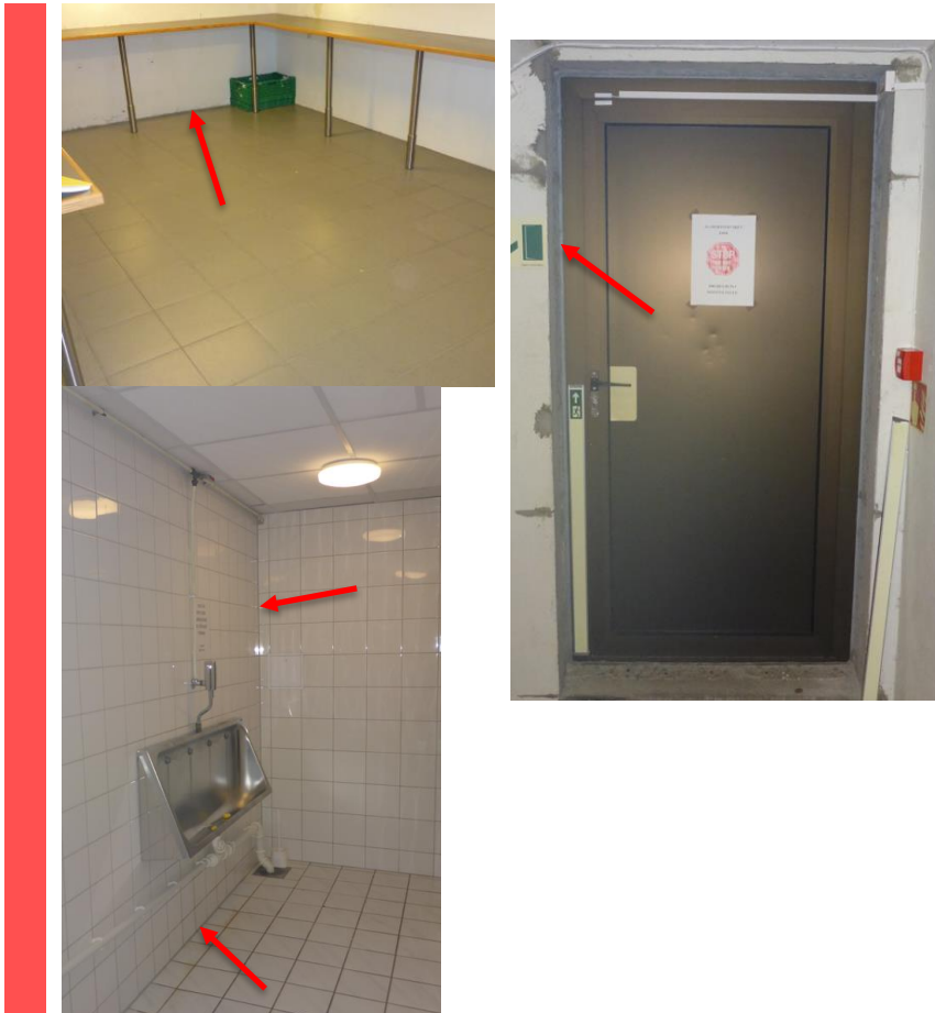
Figur 24 Ulike myke fuger i kaserne 53. Samtlige håndteres som farlig avfall mhp. ftalater og leveres til godkjent mottak.
