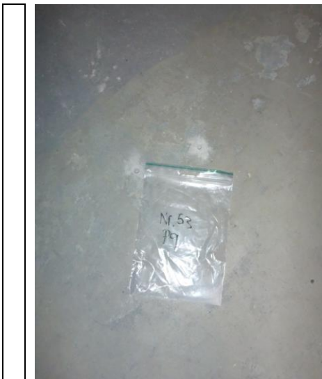
Figur 18 Betongprøve ( P9 ) av betonggulv i rom 018/mob.lager, kaserne 53. Det er påvist PCB over grenseverdi for farlig avfall i prøven. Det anbefales ny prøvetaking av betonggulvet da det er usikkert om prøveresultatene er reelle eller skyldes kontaminering fra overliggende maling.
