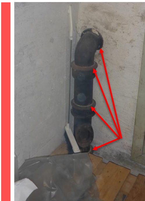
Figur 5 Soilrør med fire blyskjøter i rom 006 i kjelleren på kaserne 52. Det kan være asbestholdig tettingsmasse skjult bak blyet i skjøtene, eventuelle pakninger håndteres som asbestholdige.
