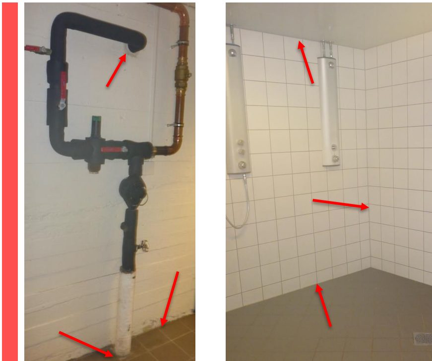
Figur 23 Ulike myke fuger i kaserne 52. Samtlige håndteres som farlig avfall mhp. ftalater og leveres til godkjent mottak.
