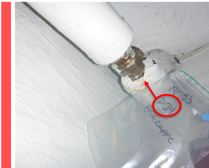
Figur 9 Asbestholdige endekapper (P24) i rom 012/trapperom i kaserne 53.
