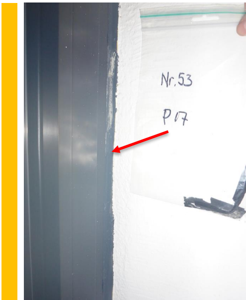
Figur 13 Svart fugemasse (P17) rundt vinduer i rom 119/korridor i kaserne 53 er analysert for asbest, men asbest er ikke påvist. Det antas at fugemassen inneholder ftalater, se kapittel 7.7.3.
