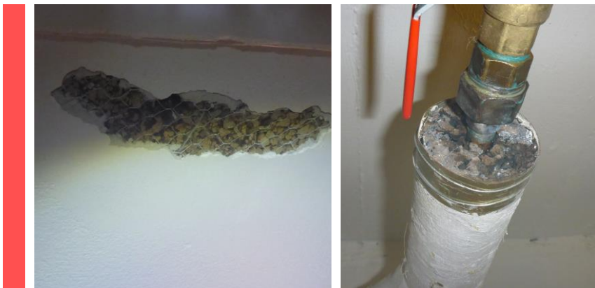
Figur 28 T.v. Korkisolasjon i nedsenket himling i rom 120/VF i kaserne 53. T.h. Korkisolasjon rundt rør i rom 010/korridor i kjelleren i kaserne 53. All korkisolasjon leveres til godkjent mottak som farlig avfall mhp. PAH.
