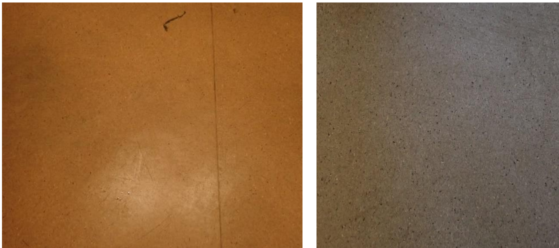
Figur 3 Eksempler på vinylbelegg i bygget. T.v. Belegg i rom 114/Garderobe D. T.h. Belegg i rom 112/kontor. Begge antas å inneholde ftalater over grense for farlig avfall .
