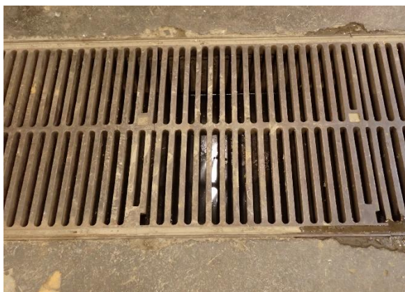
Figur 9 Betong i tilknytning til oljeutskiller antas å være oljeforurensset, men under grensen for farlig avfall.
