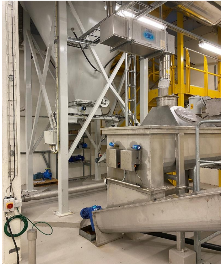
Bilde som viser eksisterende kalksilorom med slamsilo med kalkmikser som skal demonteres for å gi plass til nye mekaniske foravvannere.
