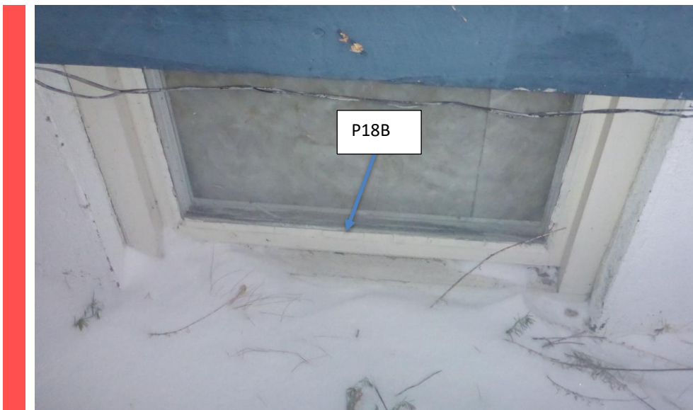
Figur 5 Vinduskitt i kjellervinduene inneholder asbest.
