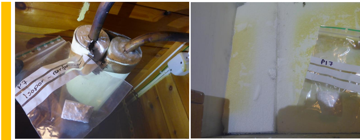
Figur 17 Rørisolasjon av isopor samt isopor brukt som isolasjon til vindu i kjellerne inneholder bromerte flammehemmere over grensen for farlig avfall. Leveres til godkjent mottak.
