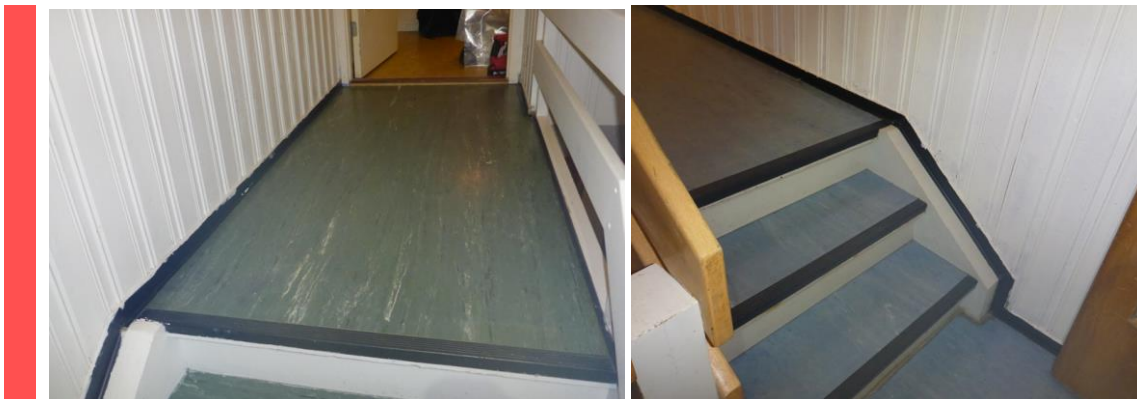
Figur 13 Vaskelister av vinyl og trappeneser, leveres til godkjent mottak som farlig avfall mhp. ftalater.
