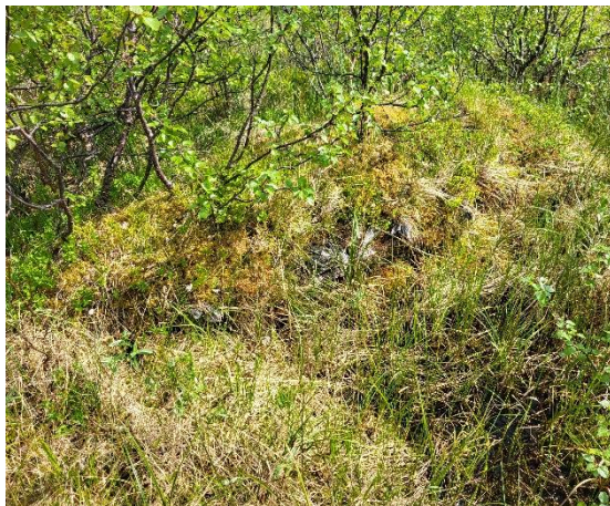
Figur 12. Overgrodd støttemur i betong, MP1.
