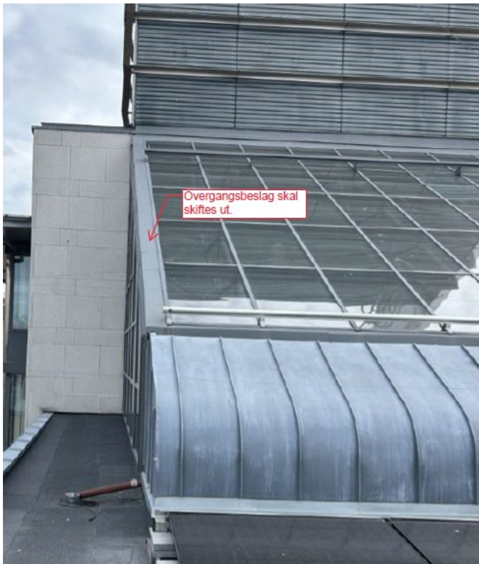
Figur 2.6-3. Bilde viser del av på beslag som skal skiftes.
