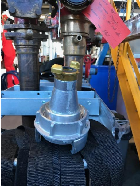
BILDE 8 OVERGANG 65 MM
