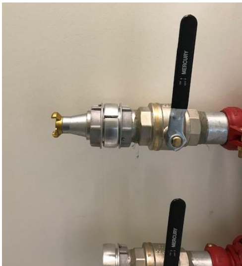
BILDE 9 OVERGANG 38MM
