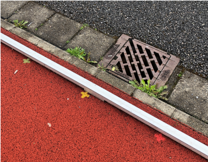
Bilete1: Kum for overvatn på Sauda stadion. Kummen ligg utanfor løpebanen som omkransar kunstgrasbanen. Lista yst på tartandekket mot asfalten er ikkje tett i botnen.
