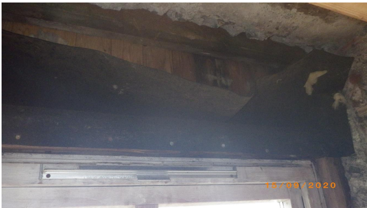
Bilde nr 11- Innvendig i bolig – Råteskade over vindu
