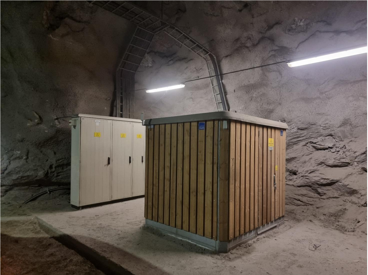
Figur 3: Trafostasjon i tunnelen.
