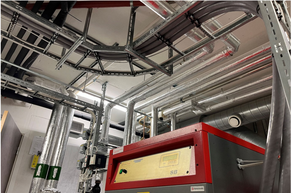
Bilete 09. Teknisk rom. Føringar i tak over eksisterande EL-kjel
