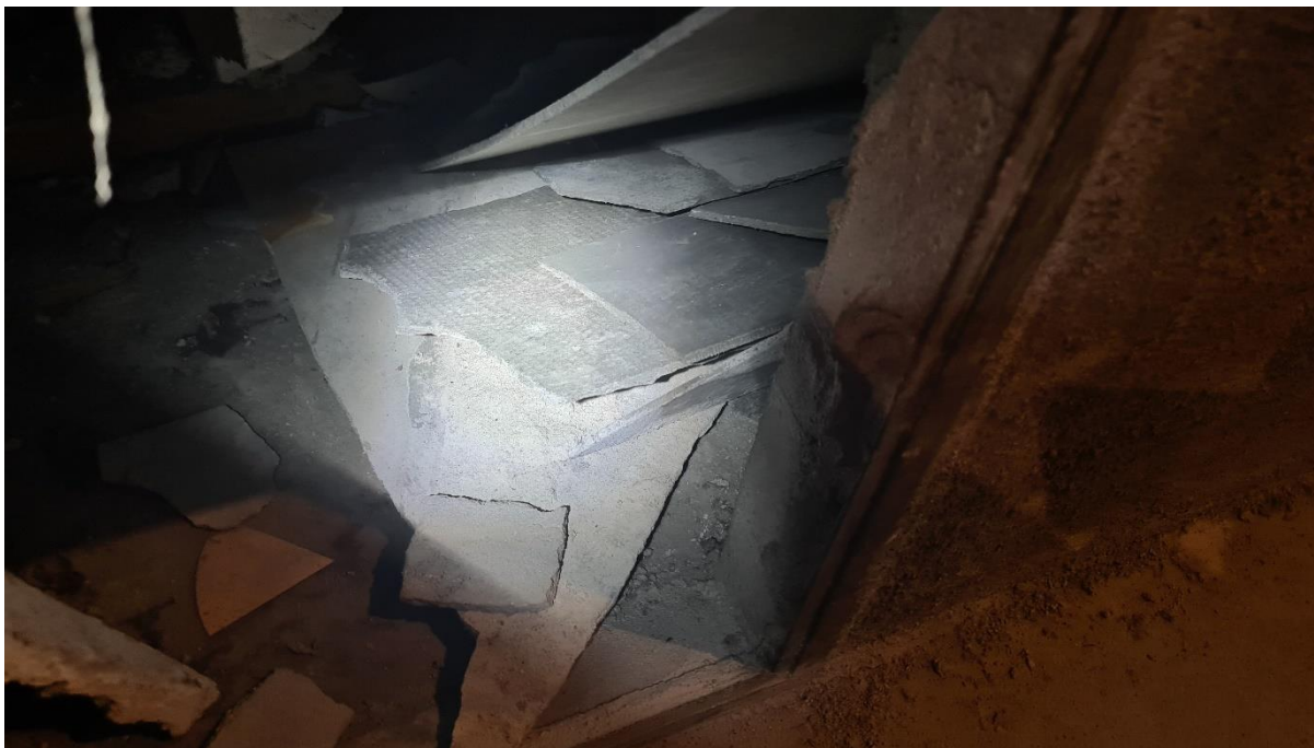
Bilde 4 – Knuste eternitplater inne i murt kanal.
