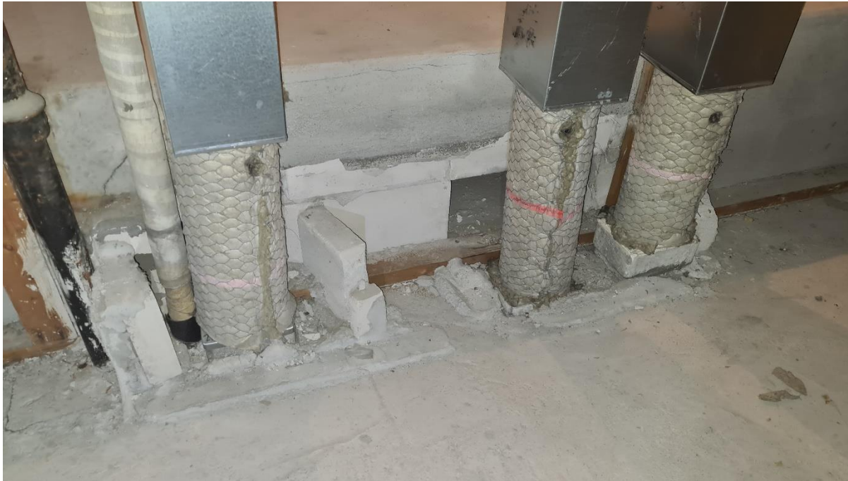
Bilde 3 – Nyere kanaler som er satt ned i gamle eternitkanaler. Kobling mellom original horisontal og vertikal kanal er knust.
