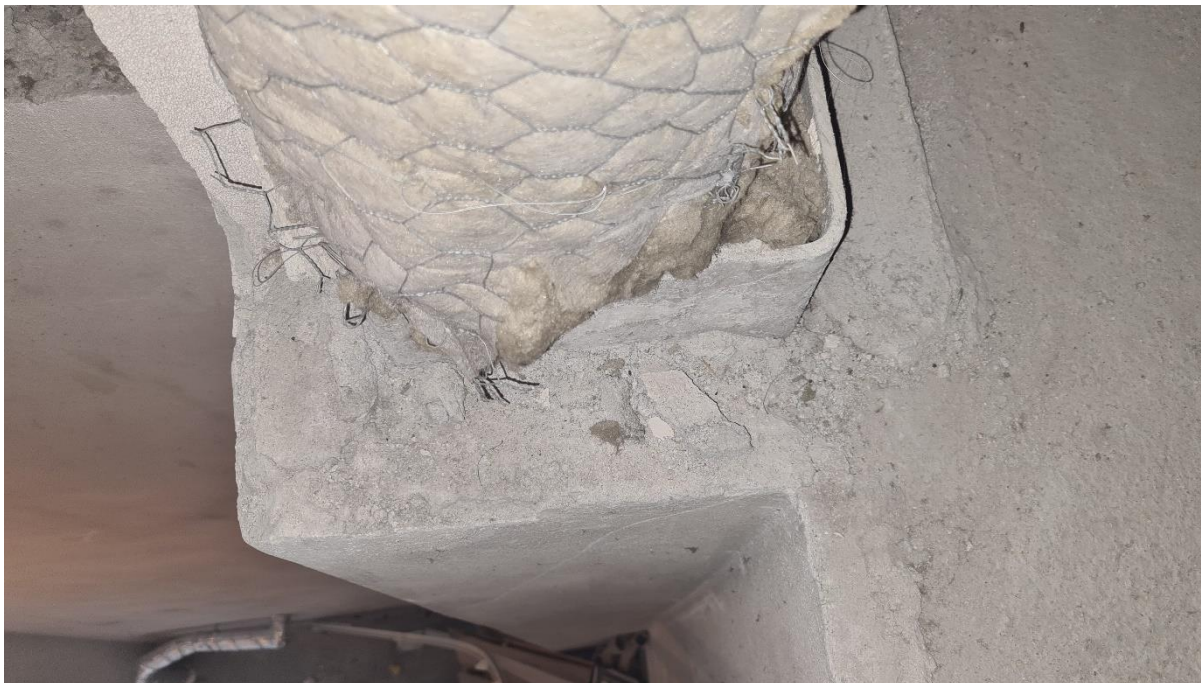
Bilde 2 – Eksempel på nyere kanal som er satt ned i en gammel eternitkanal.
