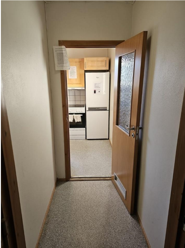
Bilde 2.16, viser kjøkken i 2.etg/3.etg (Kjøkken i 2. og 3.etg er tilnærmet lik)
