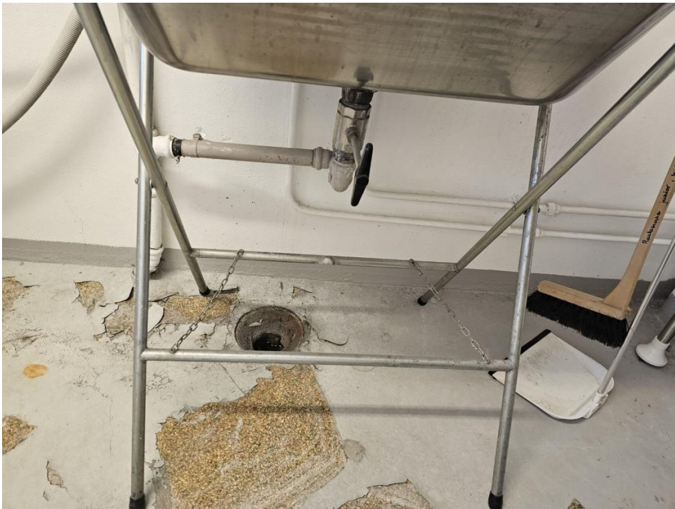
Bilde 2.13, viser gulv, sluk og standard på vaskerom i 3.etg
