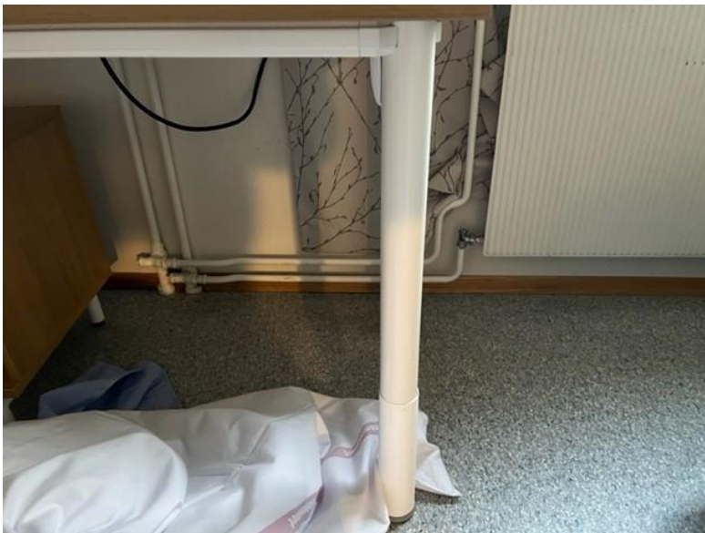
Bilde 3.4, viser forlegningsrom påkobling radiator, overgang gulv vegg
