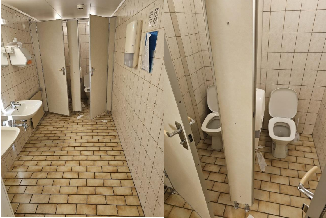
Bilde 4.4 og 4.5, viser toalett «Damer» i foajeen 1.etg. NB! OPSJON
