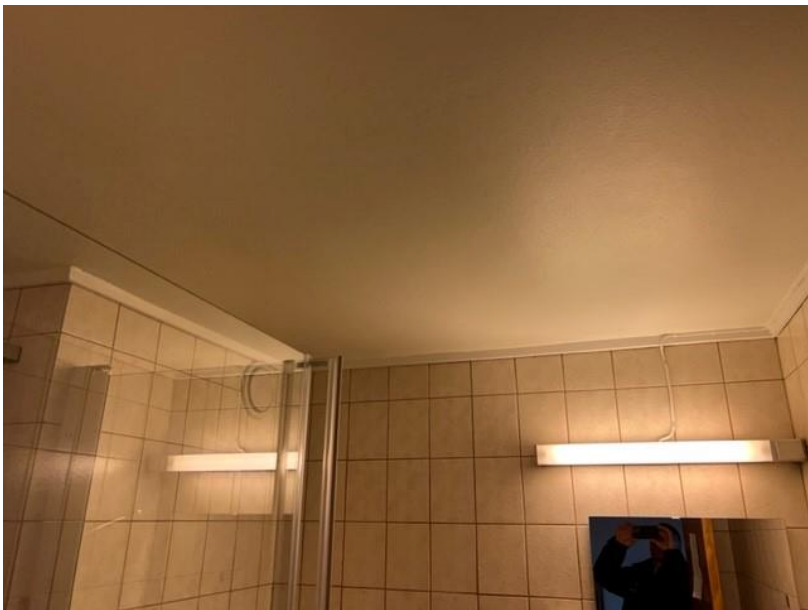
Bilde 3.8, viser himling samt lys. NB! Ingen lys i tak.
