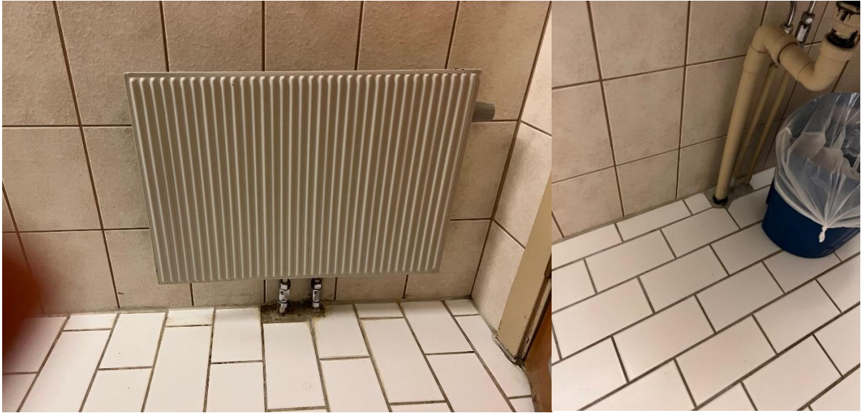
Bilde 3.9/10, viser radiator og rør til servant på bad i forlegningsrom.
