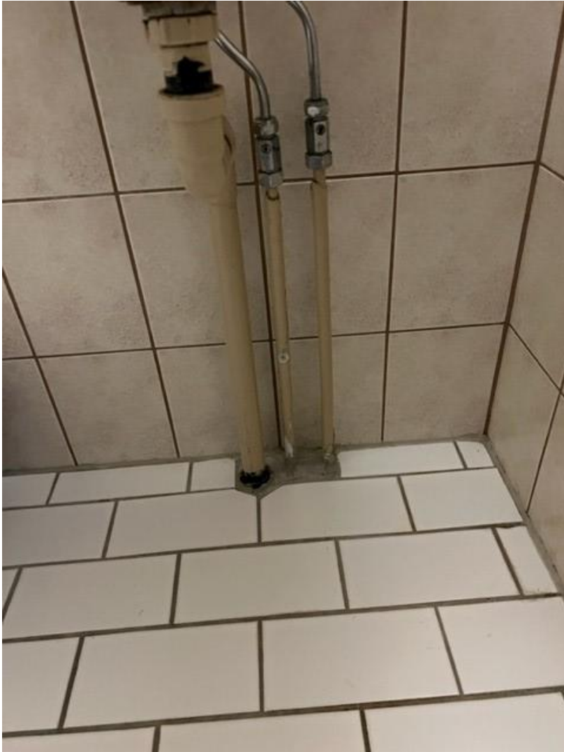
Bilde 3.7, viser servant med tilkobling på bad forlegningsrom, overgang gulv-vegg
