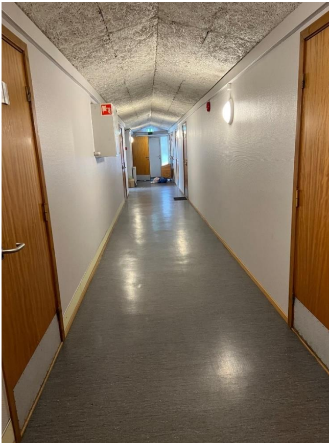
Bilde 2.1, viser korridor i 1.etg. Himling må overflatebehandles
