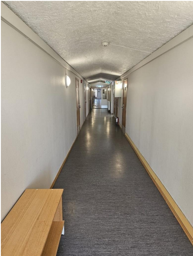
Bilde 2.3, viser korridor 3.etg, himling må overflatebehandles
