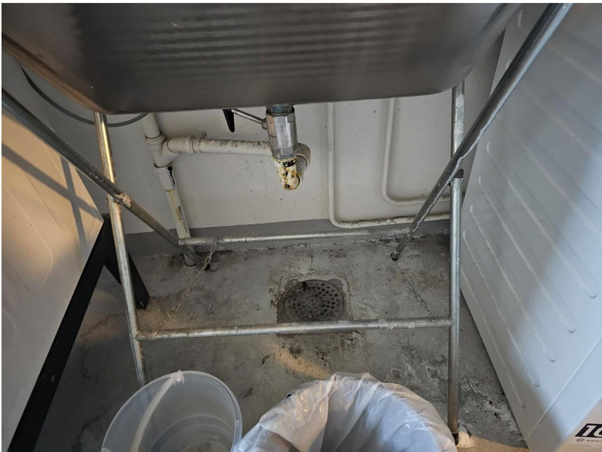
Bilde 2.11, viser gulv, sluk og standard på vaskerom i 2.etg
