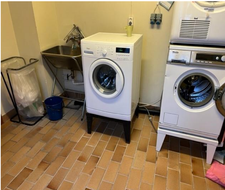
Bilde 2.9, viser vaskerom 1.etg, sluk og skyllekar, opplegg for vaskemaskin/ tørketrommel
