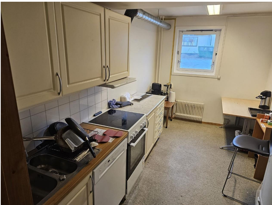
Bilde 2.15, viser kjøkken 1 etg, innredning, luftekanal samt røropplegg til radiator.
