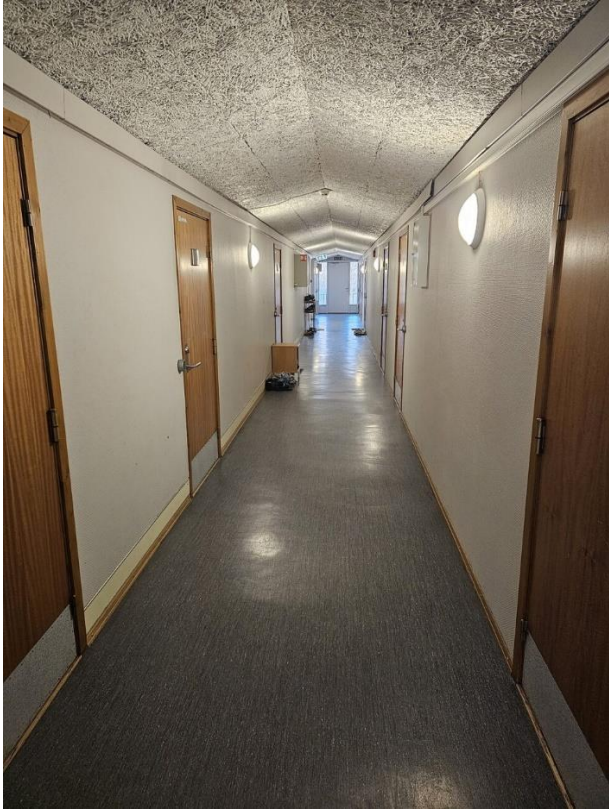
Bilde 2.2, viser korridor 2.etg, himling må overflatebehandles
