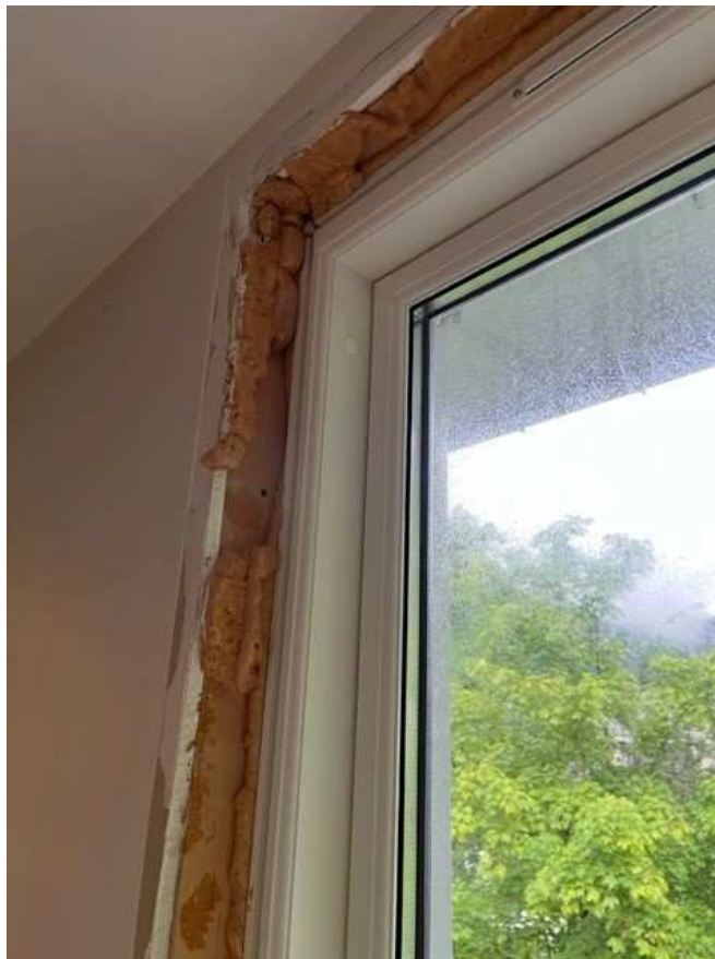
Bilde 2 Vindu tett med byggeskum.
