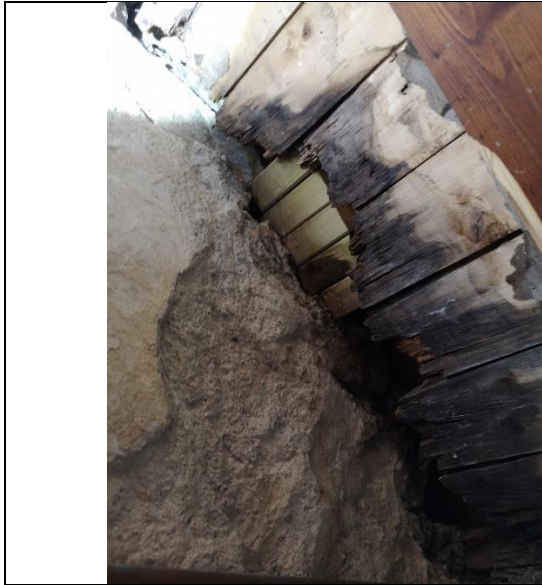
261-1: Siderom over våpenhus. Skadet taktro.
