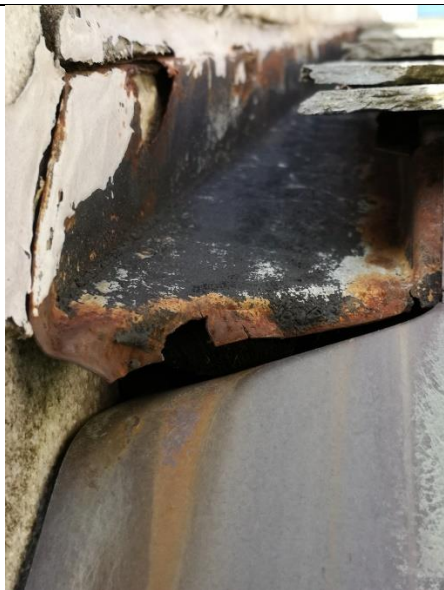
265-2: Beslag i skottrenner og andre beslag har store hull og har liten restverdi
