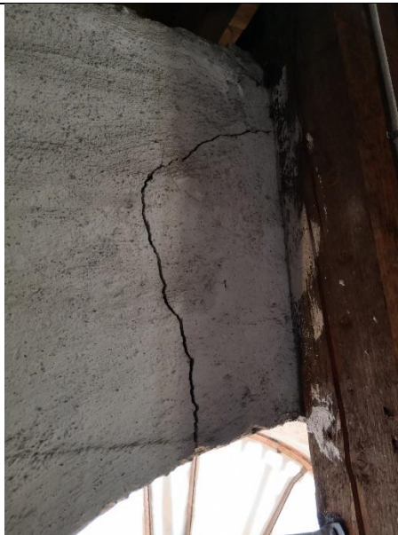
236-7: Tårn: Sprekk i fasade på grunn av lastpåkjenning av klokkespill
