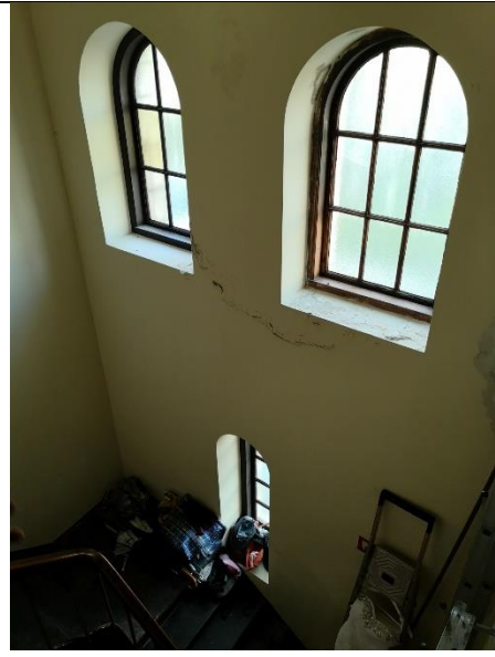
236-5: Trapperom i våpenhus ned til kjøkken. Sprekk i vegg
