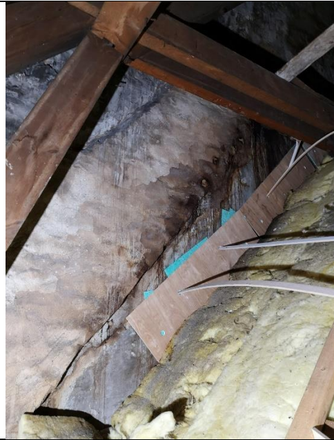
236-1: Innvendig gavlvegg mot vest. Pipeløp leder vann inn gjennom begge murvanger og lekker inn i konstruksjonen
