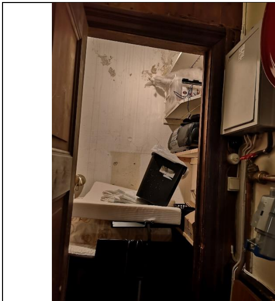
236-2: Innvendige flater med vannskader. Sakristi. Pipeløpet fører inn vann fra
