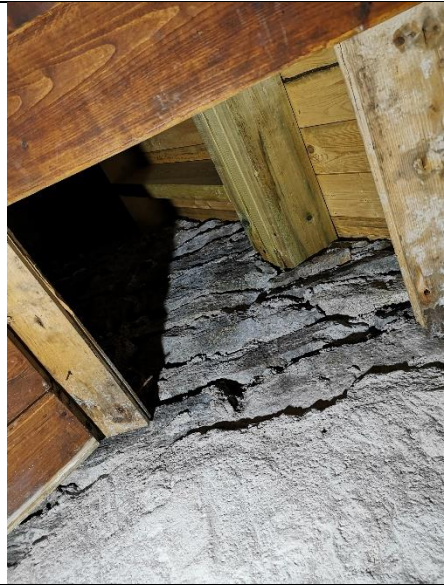
261-2: Siderom over våpenhus. Impregnerte bjelker som er satt inn. Erstattes med nye bjelker i riktig materiale.
