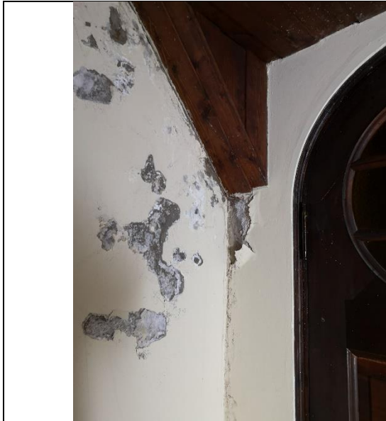
236-4: Siderom over våpenhus. Malingsavskalling på grunn av vanninntrenging fra taktekking
