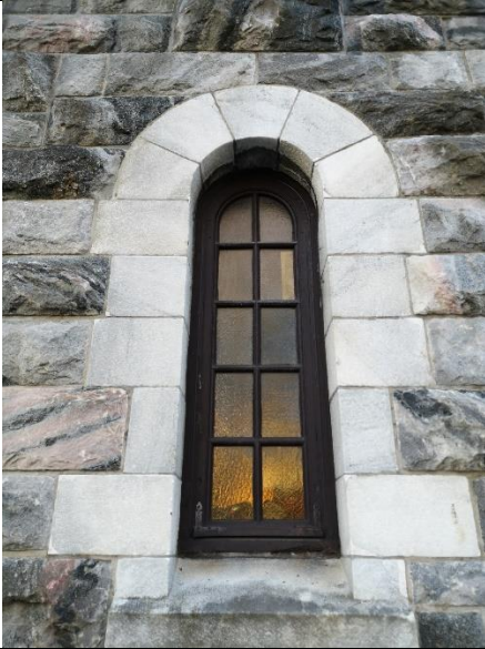
234-1: Eksempel på vindu som skal settes i stand
