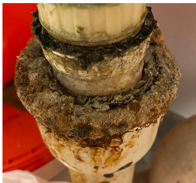
Bilde B8: Asbestholdig kitt på soilrør
