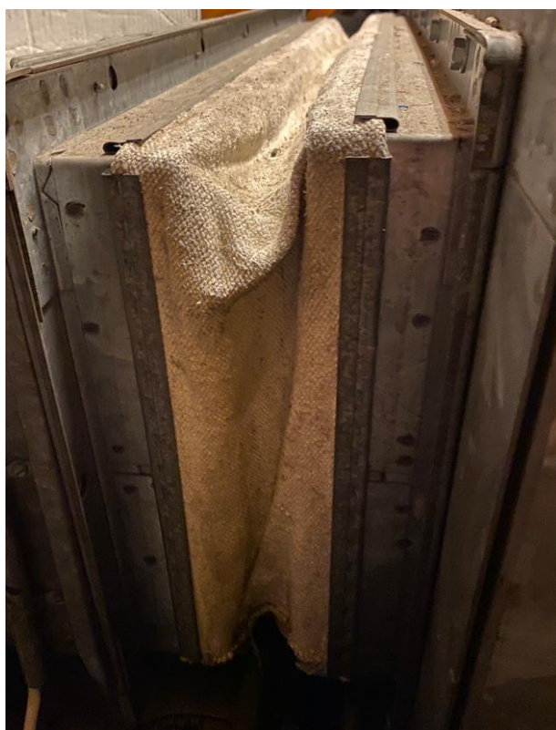
Bilde B7: Asbestholdig tekstilmansjett på ventilasjonskanaler
