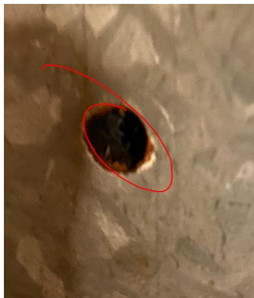
Bilde B2: P03 asbestholdig isolasjon fra innsiden av kanal
