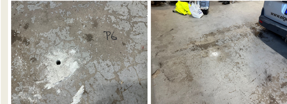
Figur 25 – Betong i gulv på grunn i lager-/verkstedbygning (P6).
