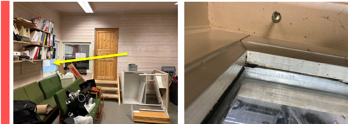
Figur 15 – Vindu med klorparafiner.
