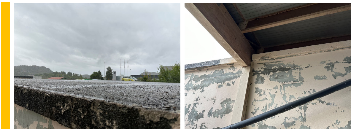
Figur 26 – Betong i yttertakk i garasje (P7).
