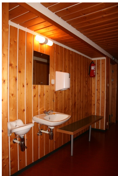
Vask og drikkefontene i korridor. Opphavsrett: Statsbygg.
