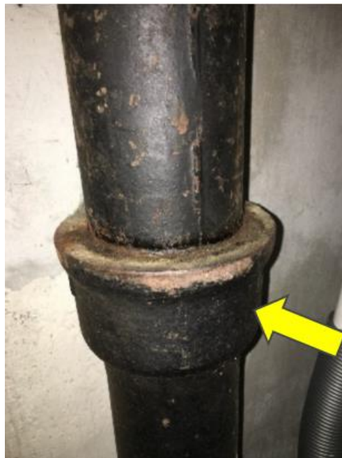
Figur 1 Gammelt avløpsrør av støpejern (ikke fra denne kartleggingen). Pilen viser plassering av eventuell asbestholdig tettemasse. Det er kun denne typen støpejernsrør vi kjenner til at det kan være brukt asbest i. Det er imidlertid ikke uvanlig at rørene er malt utenpå.
