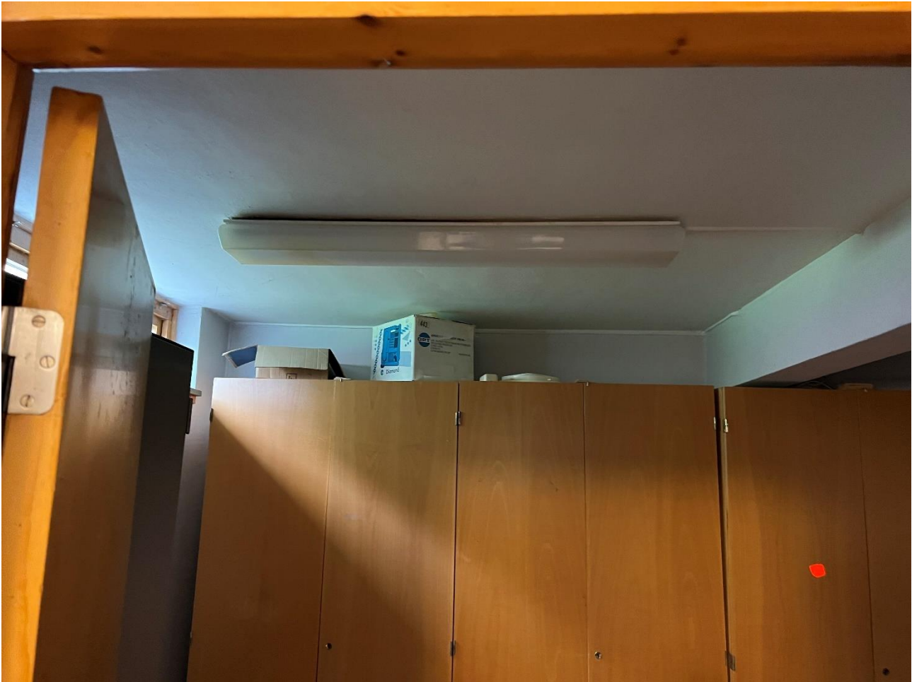
Figur 2: Gammel lysarmatur som kan inneholde kondensatorer med PCB i Paviljong 7.
