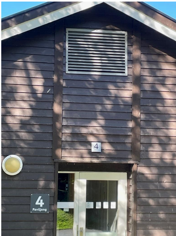
Figur 6 Eksempel fra P4 med ny ventilasjon installert. I paviljong 7 skal panel skjøtes i slik at sporene av hull ikke synes.
