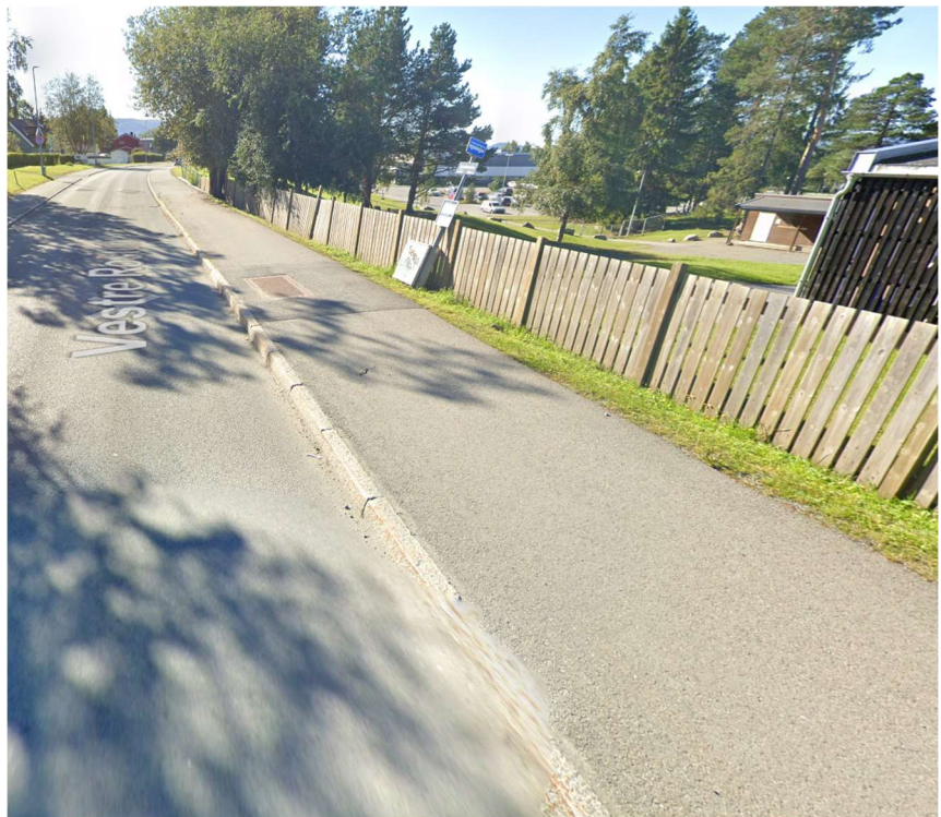
Holdeplass i sørgående retning: Det mangler taktil merking og kantstein er lav.
