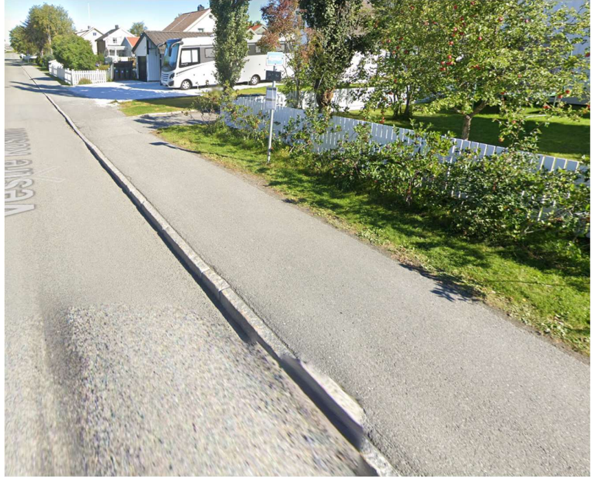
Holdeplass nordgående retning: Det mangler taktil merking og kantstein er lav.
