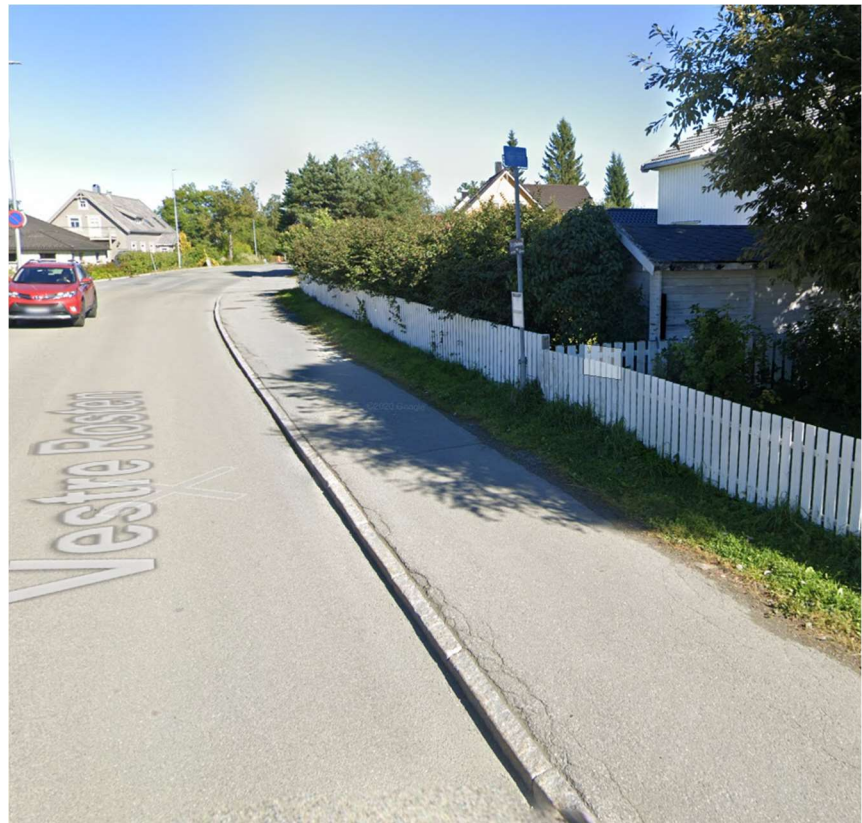
Holdeplass i nordgående retning: Det mangler taktil merking og kantstein er lav.
