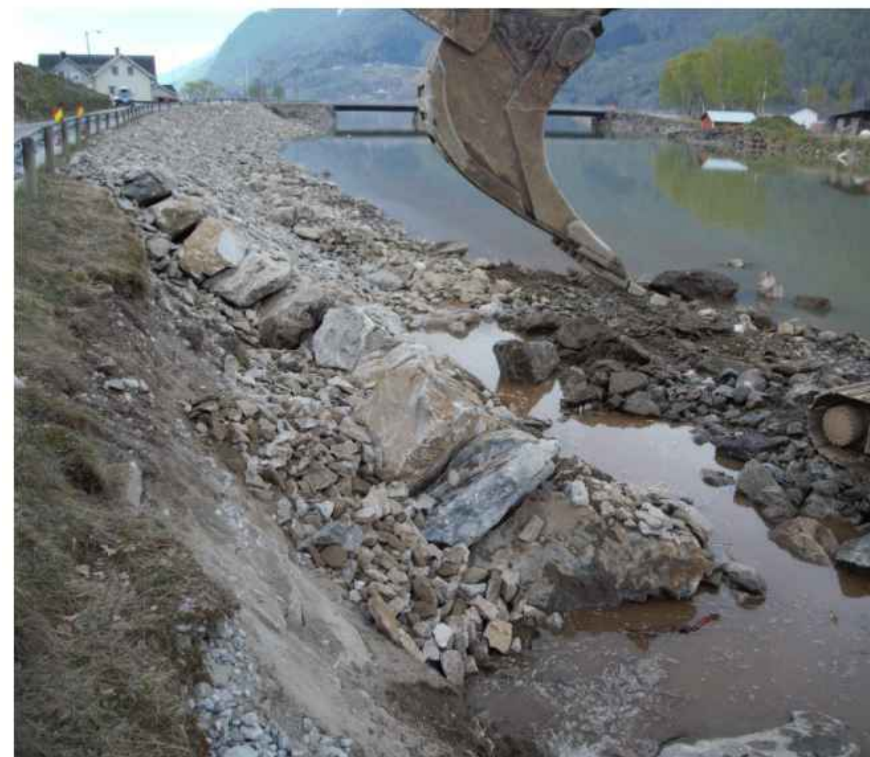
Figur 1: Erosjonssikring med plastringstein under utføring. Mørkriselvi, Luster kommune. (Foto: Jomar Bergheim, NVE)
