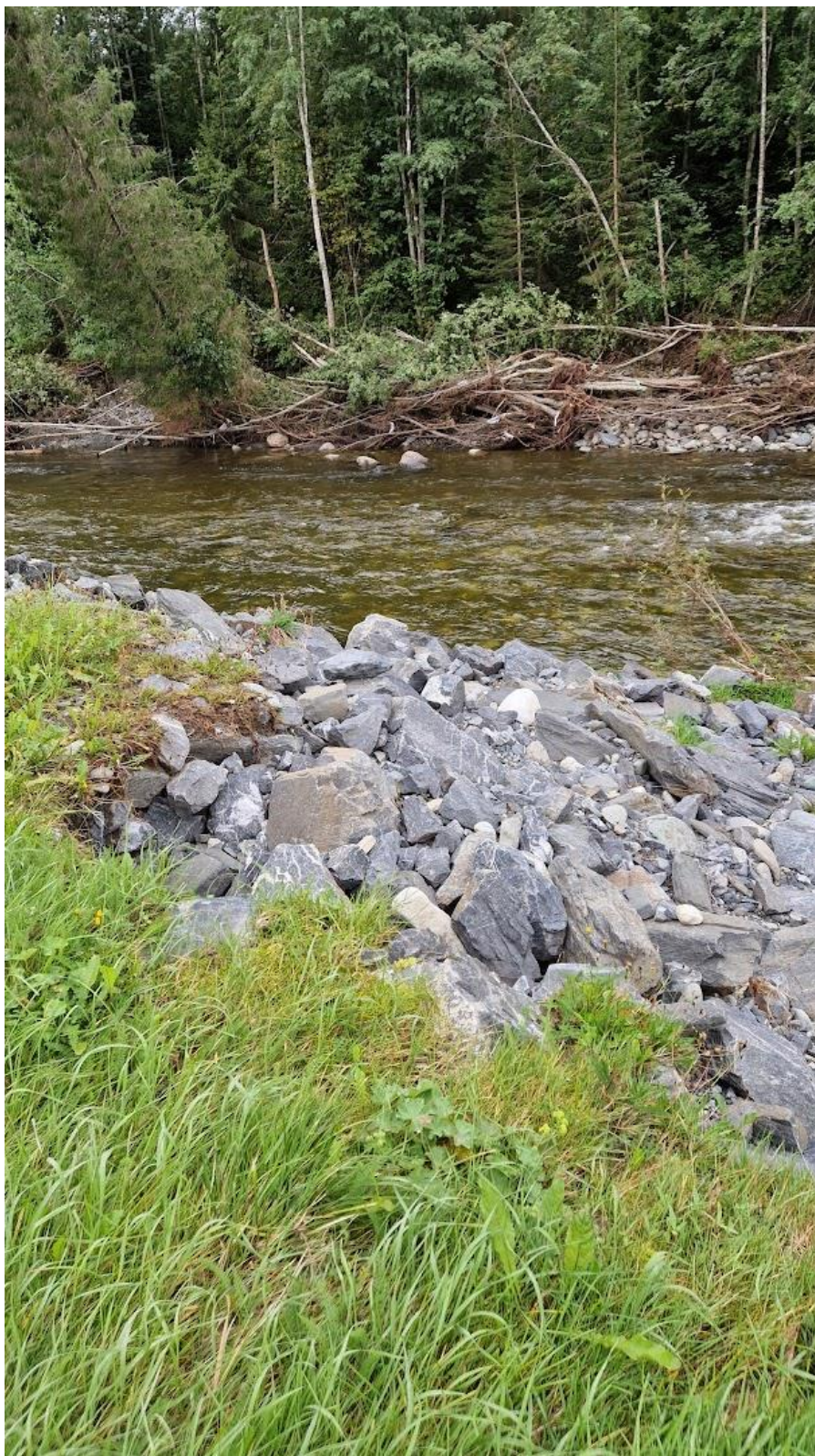
Erosjonsskade på det nordvestre hjørnet på vollen
